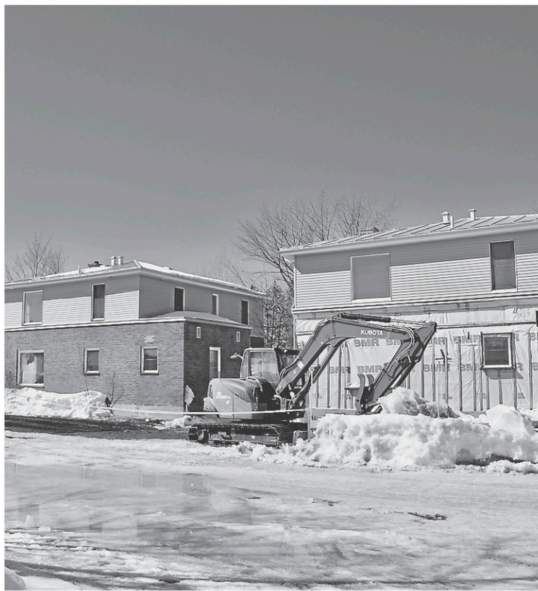
Ces maisons, situées sur le terrain de l'hôpital de Mont-Joli, contiennent de l'amiante et la première à gauche est infestée de mérule pleureuse.
