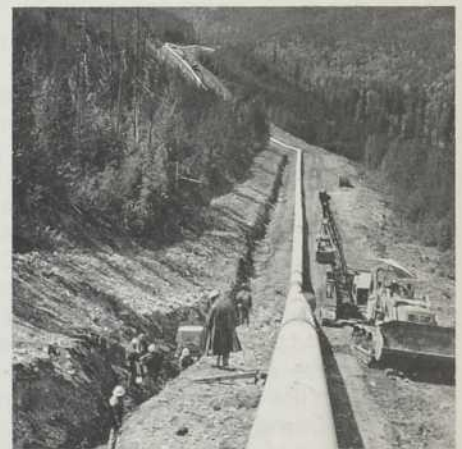
Pipelines et gazoducs
