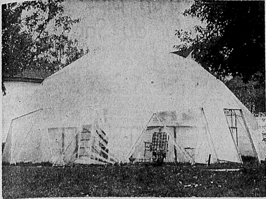
PISCINE FUTURISTE — Après avoir construit lui-même une tente-roulotte il y a quelques années, M. Gérard Auger, d'Arvida, décidait en 1970, d'entreprendre l'érection de ce dôme.
