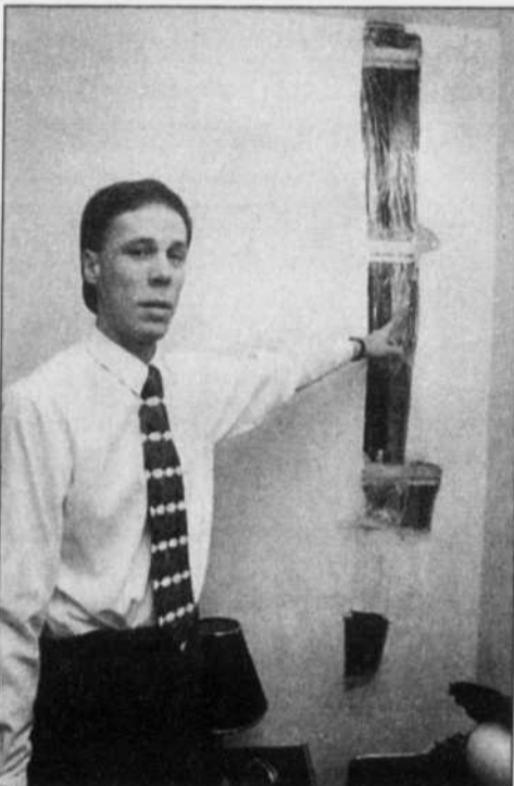
Des tuyaux apparents dans une chambre à coucher, pas de quoi faire de beaux rêves... (Photo: Richard Gauthier)
