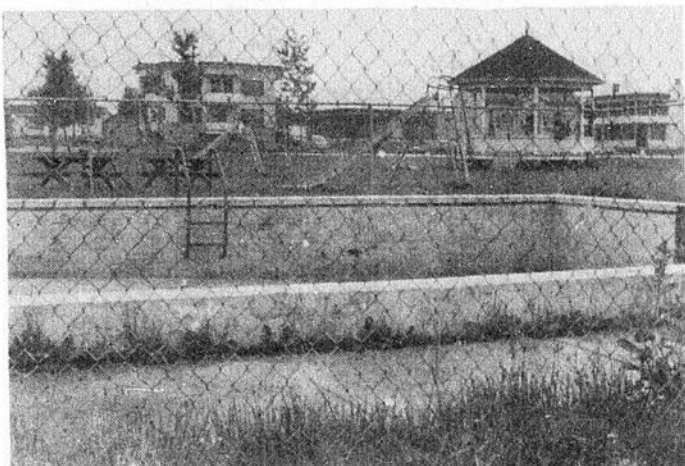
Malgré les pluies abondantes que nous avons connues depuis le mois de juin, la piscine située au parc de L.O.T.J. de Louiseville est encore à sec.
