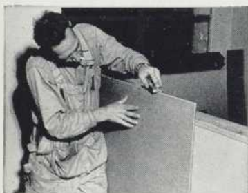
LE RABOTAGE se fait comme pour du bois. Ici le biseau obtenu avec un rabot ordinaire a donné aux panneaux des joints en V du plus bel effet.
