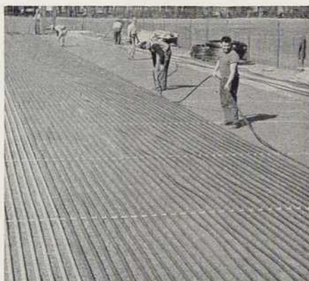
La flexibilité des tuyaux de plastique est ici démontrée. L'usage d'une tuyauterie légère permet la restauration facile des terrains de jeux lorsque la saison de patinage est terminée.
