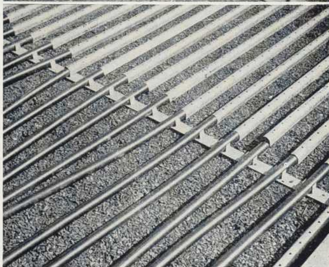
La tuyauterie de plastique est recouverte d'une gaine protectrice en demicercle, faite de tôle galvanisée.
