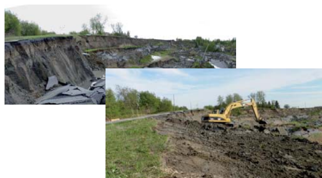
Figure 2.8 Paroi arrière du glissement adoucie mécaniquement dans les premiers jours qui ont suivi le glissement.
