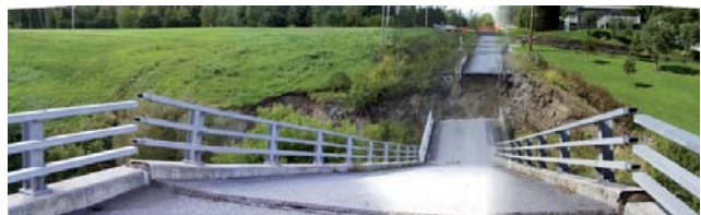
Figure 4.1 Photographie du glissement qui affecta le pont de la route Bourgchemin qui enjambe la rivière Salvail près de son embouchure.
