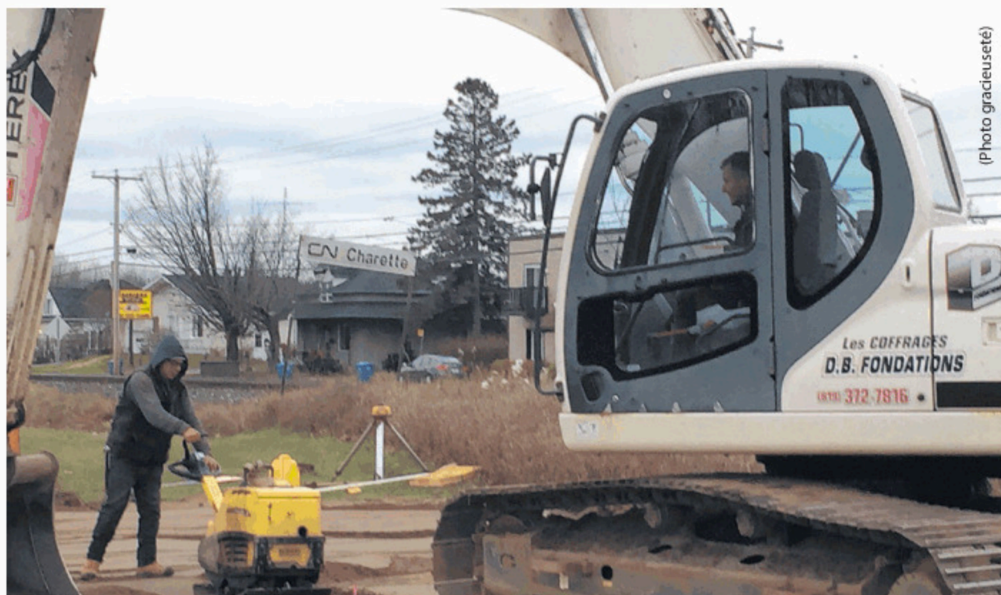
Les bénévoles sont à pied d'œuvre pour le début des travaux de construction de la gare. (Photo gracieuseté)
