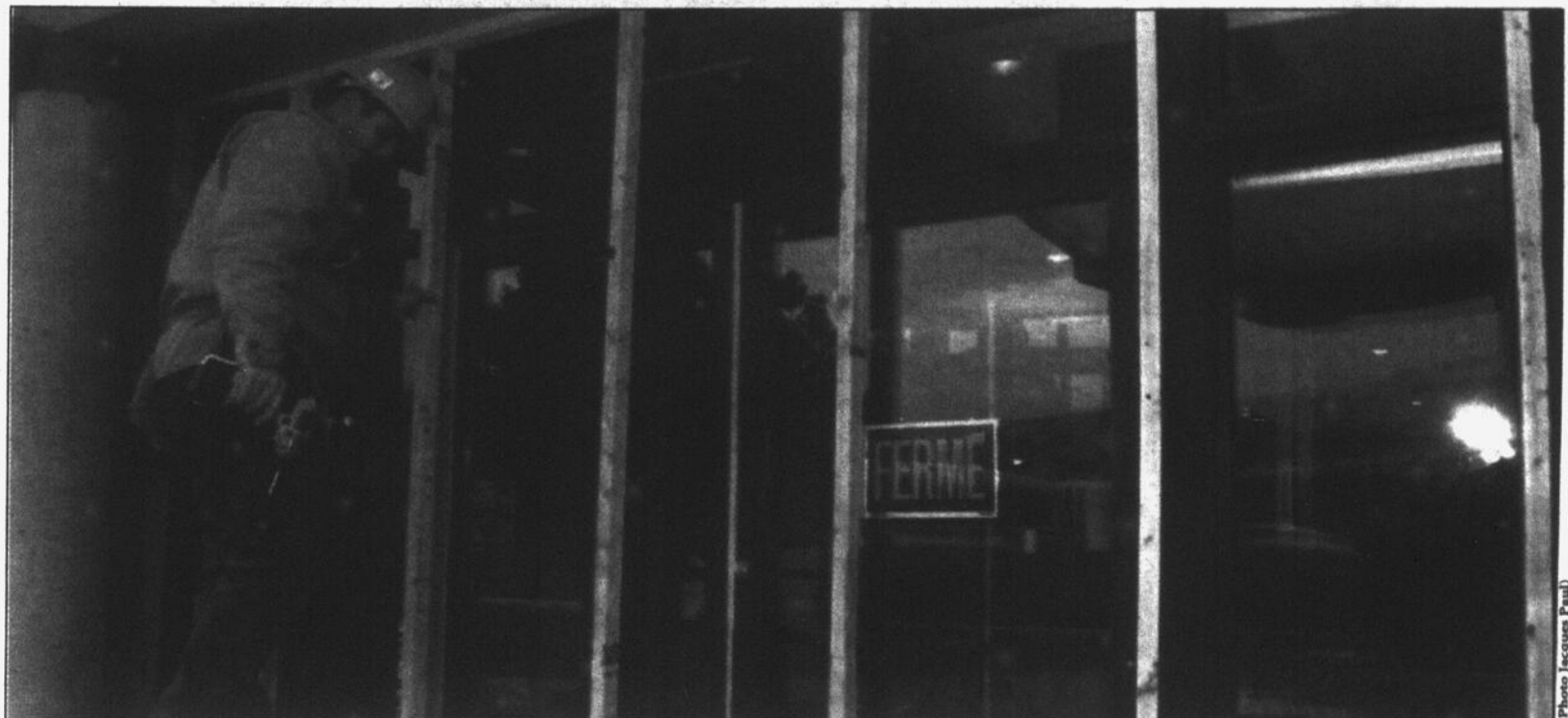
L'hôtel Relais Gouverneur de Saint-Jean-sur-Richelieu aura été fermé durant 66 jours. Les feuilles de contreplaqué qui avaient été installées dans les portes et les fenêtres seront bientôt enlevées.
