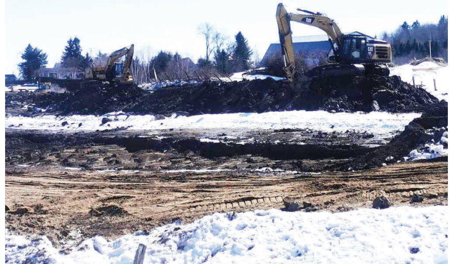
Des travaux préparatoires sont en cours sur les futurs terrains situés derrière la rue Roy-Comeau à Baie-Saint-Paul.
