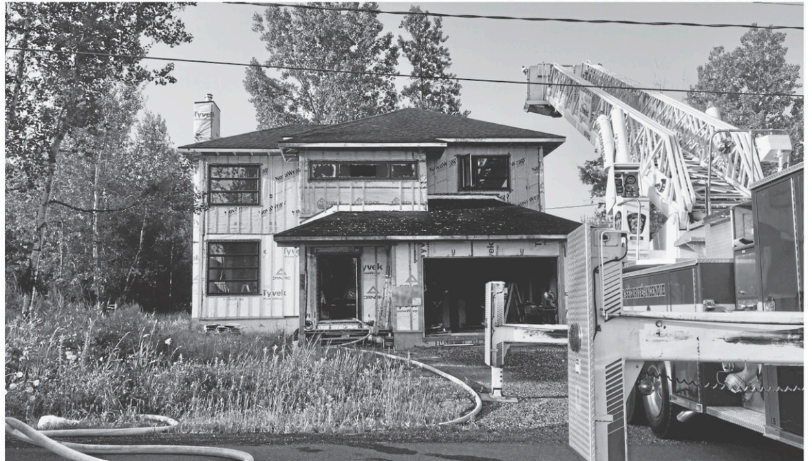
Une résidence en construction a été endommagée par un incendie. Les dommages se chiffrent entre 20 000 $ et 30 000 $. — PHOTO FOURNIE
