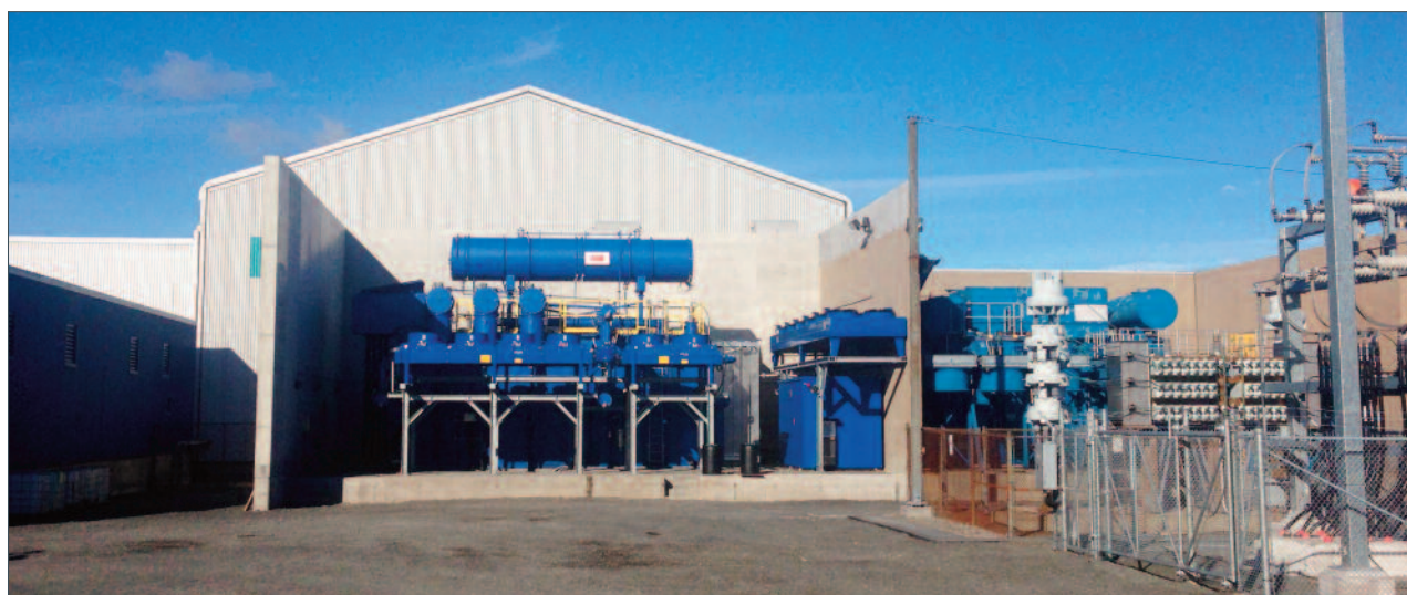
Le transformateur-redresseur en fonction, communément appelé R7, sous un ciel bleuté.
