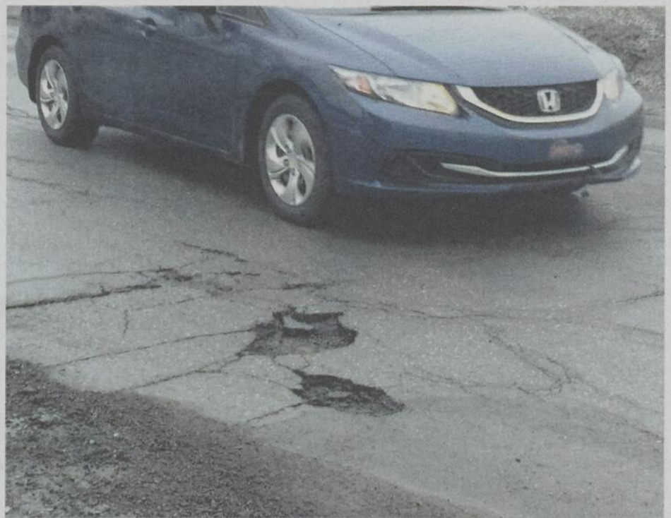
Les nids-de-poule, comme celui-ci qui se retrouve à l'intersection la 5e Avenue et de la 93e rue, sont peu présents sur le territoire de la Ville de Saint-Georges.
