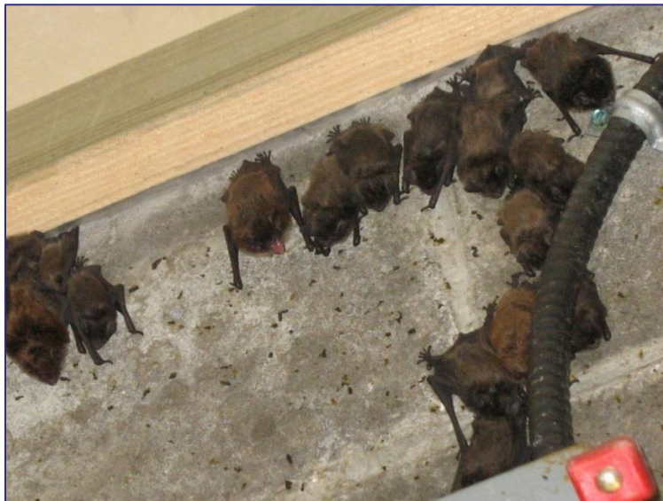
Figure 4. Colonie de chauves-souris avec guano sur le mur
