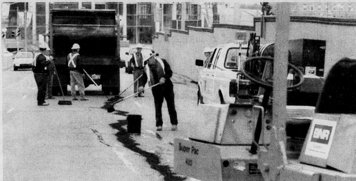
Les travailleurs réparent une fissure dans la rue Mackenzie, à Ottawa, qui s'est affaissée hier.
