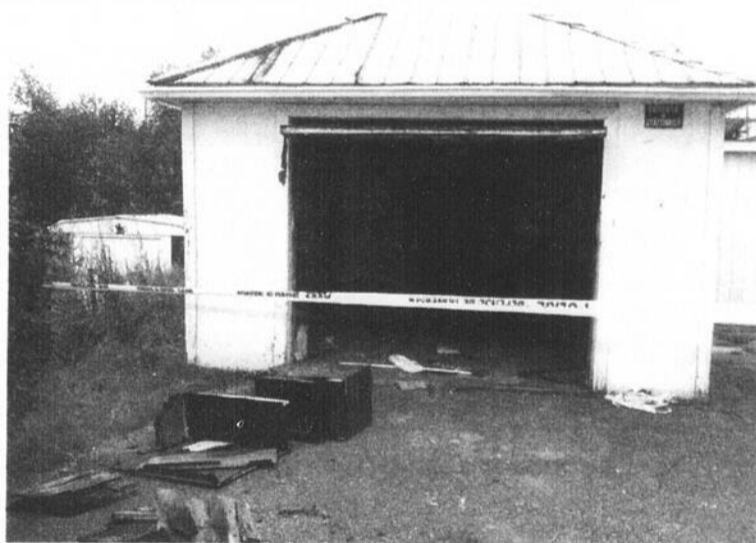
FLAMMES - Les flammes ont endommagé le plancher et un meuble se trouvant à l'intérieur, causant quelques milliers de dollars de dommages à l'ensemble de la remise. (Photo Sylvain Dufour)
