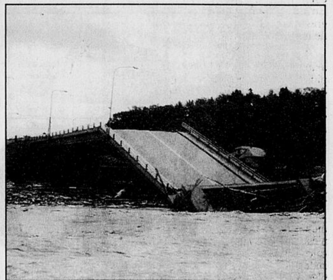
Un tremblement de terre n'aurait pu mieux faire: le béton armé de ce pont n'a pas tenu le coup après le déluge de ce week-end au Saguenay.
