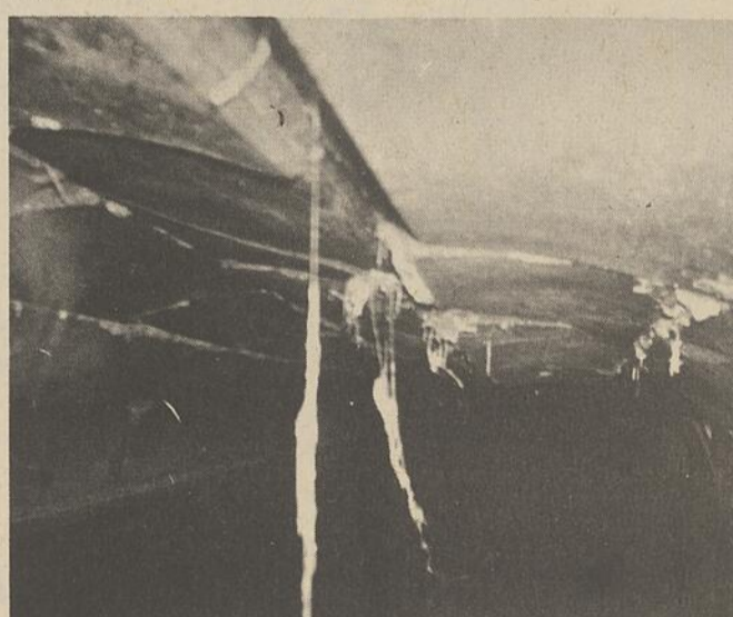
L'égout qui fut construit en 1939, sur la rue Robinson, a Granby, menace de s'effondrer sur toute sa longueur. Comme le laisse voir cette photo prise à l'intérieur de cet égout, les blocs de tulle se laissent et peuvent tomber à l'intérieur d'une journée à l'autre.
