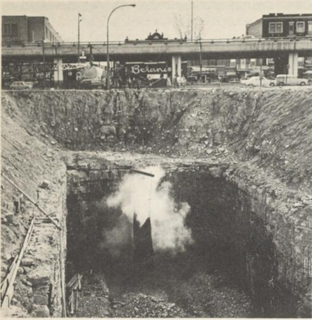
Dynamitage et travaux d'excavation de la future station Crémazie. On aperçoit le boulevard métropolitain.
