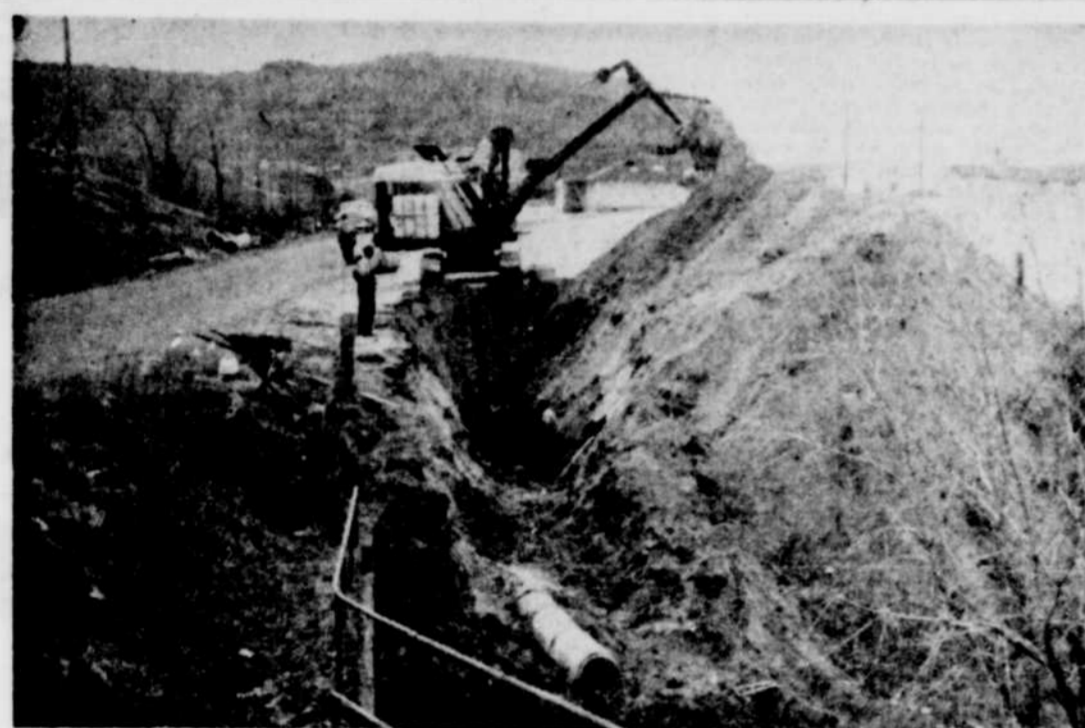
LES TRAVAUX DE CONSTRUCTION d'un système d'égout au quartier Bel-Air, à La Tuque, progressent rapidement comme l'atteste cette photo. L'addition servira à desservir les nouvelles constructions présentement en chantier sur les rues Beaumont, ou Boulevard et Carré Beaumont.
