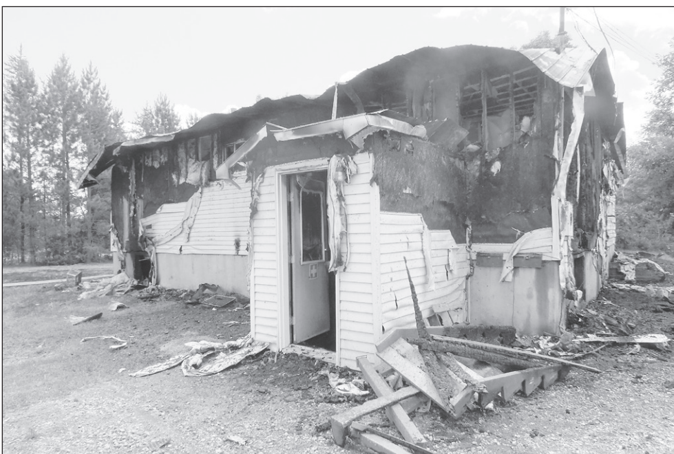
Il faudra totalement reconstruire le bâtiment.
