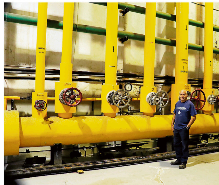
Selon l'ingénieur Michel Maltais, le problème ne réside pas dans la désuétude de la centrale ou même ses opérations, mais dans sa dimension et sa capacité de production de vapeur qui dépasse aujourd'hui de beaucoup les besoins des clients de 1951, année de mise en service du système de bouilloires. — PHOTO LE QUOTIDIEN, YOHANN GASSE
