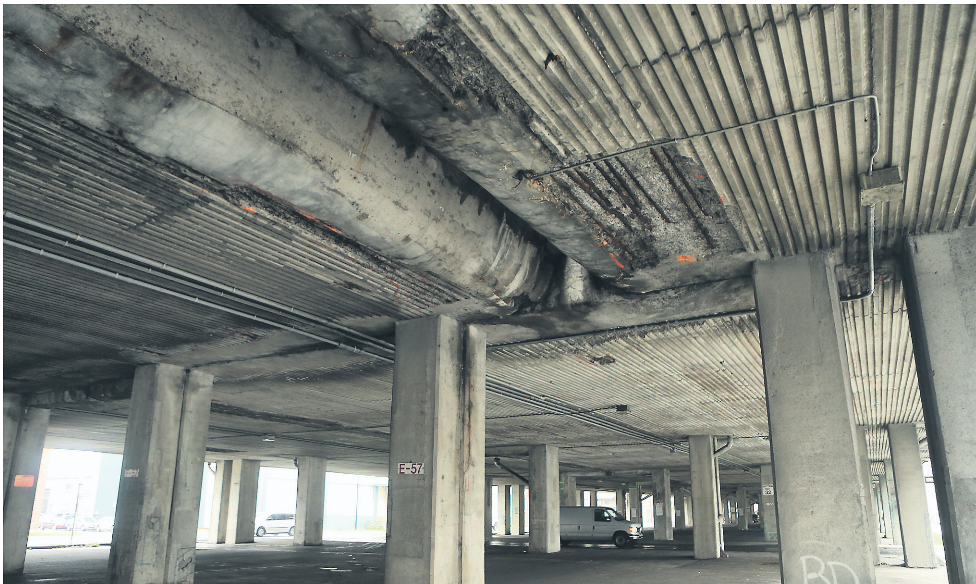
La corrosion et les dommages causés par le délamination du béton sont visibles partout sous la structure qui surplombe l'avenue Musset.
