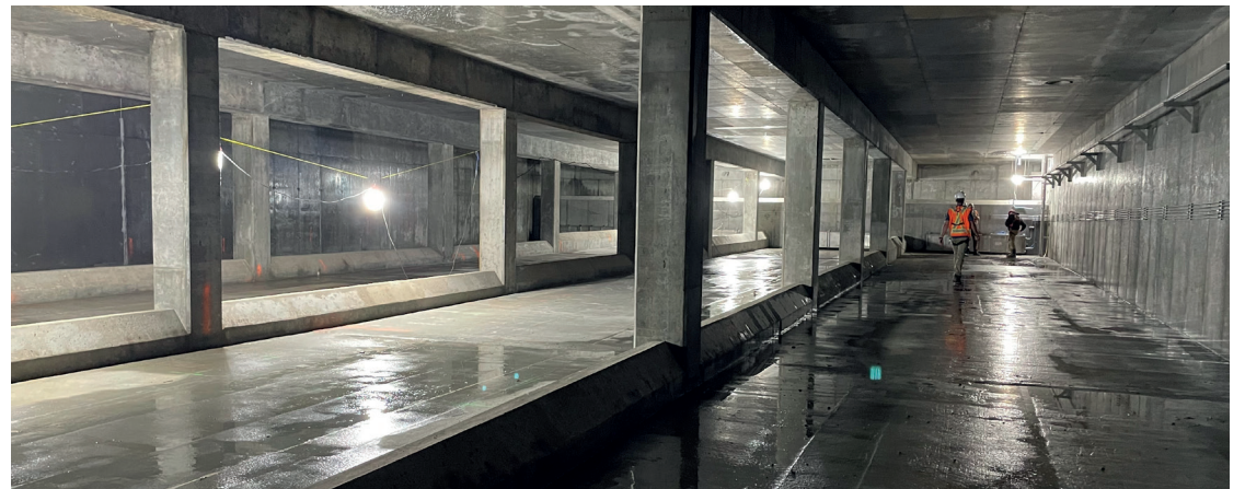
Une petite partie du bassin souterrain de rétention des eaux, composé de quatre grands couloirs longs de 50 mètres. Photo - Pierre Paquet
