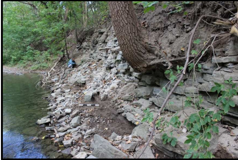
Photo 10 : Parement ouest résiduel de l'aile nord-est du barrage Brown, vers le nord (M. Goyette, Ville de Québec, A-15-12-81).
