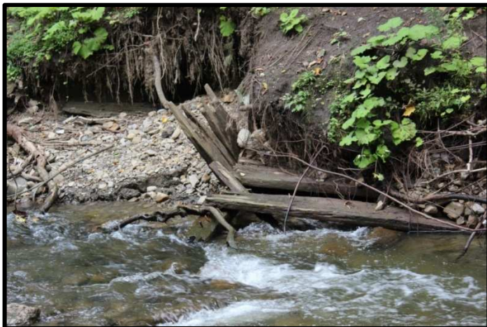
Photo 31 : Vestiges de la chaussée du barrage du moulin Henderson, dans le parc de la Rivière-Beauport ou site CfEt-29 (M. Goyette, Ville de Québec, A-15-07-18).
