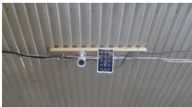
Figure 16 Caméra et lampe infrarouge latérale installée en angle.
