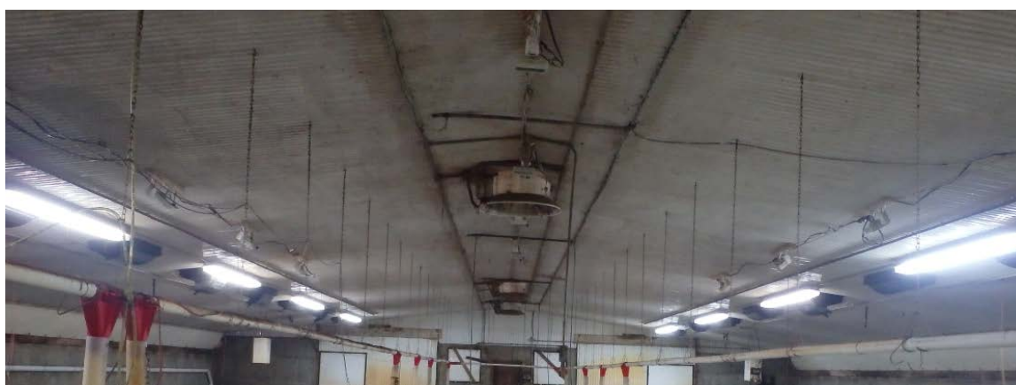
Figure 15 Caméras et lampes infrarouges installées au plafond.
