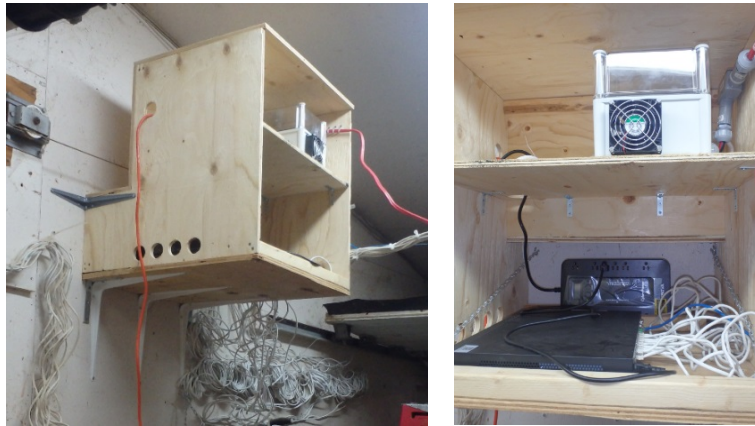
Figure 17 Tablette de la salle A abritant l'onduleur pour protéger le circuit, le commutateur des caméras et le transformateur alimentant les lampes infrarouges.
