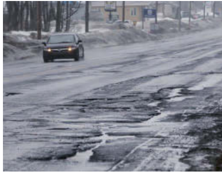
La section du boulevard Fiset, entre le rang Ste-Thérèse et le chemin de Lavallière, est la plus problématique.
