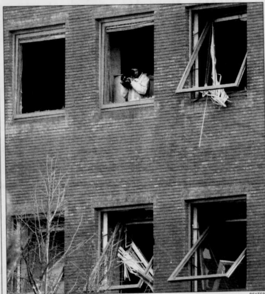
Voici un aperçu des dommages provoqués par la voiture piégée de l'ETA.
