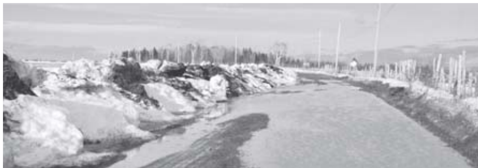
Inondation dans le chemin du Vide au printemps 2016. Photo : Courtoisie
