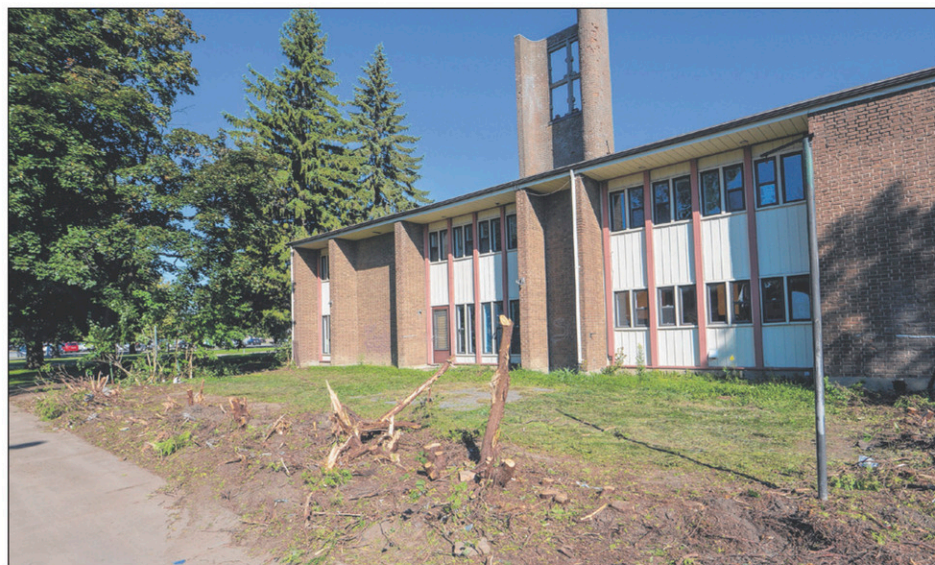
Les introductions par effraction et le vandalisme sont fréquents à l'église Saint-Gérard. Pour améliorer la visibilité, les propriétaires ont coupé une série d'arbustes qui cachaient les fenêtres du presbytère.
