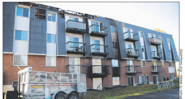
Au total, 11 logements ont été endommagés par l'eau, la fumée et le travail des pompiers.
