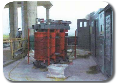
Vue du transformateur debout après l'accident.
