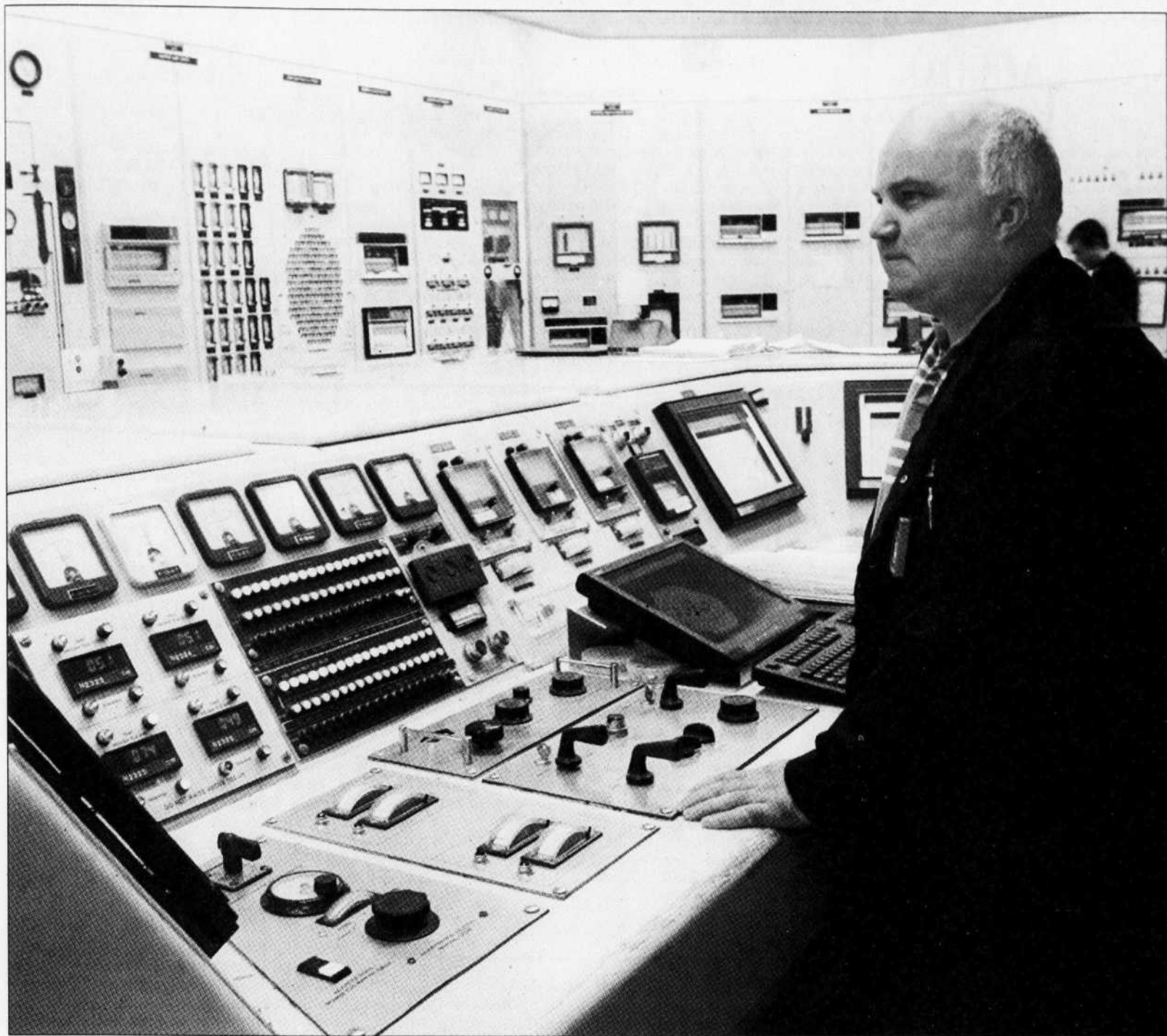
La salle de contrôle du réacteur nucléaire de Chalk River.
