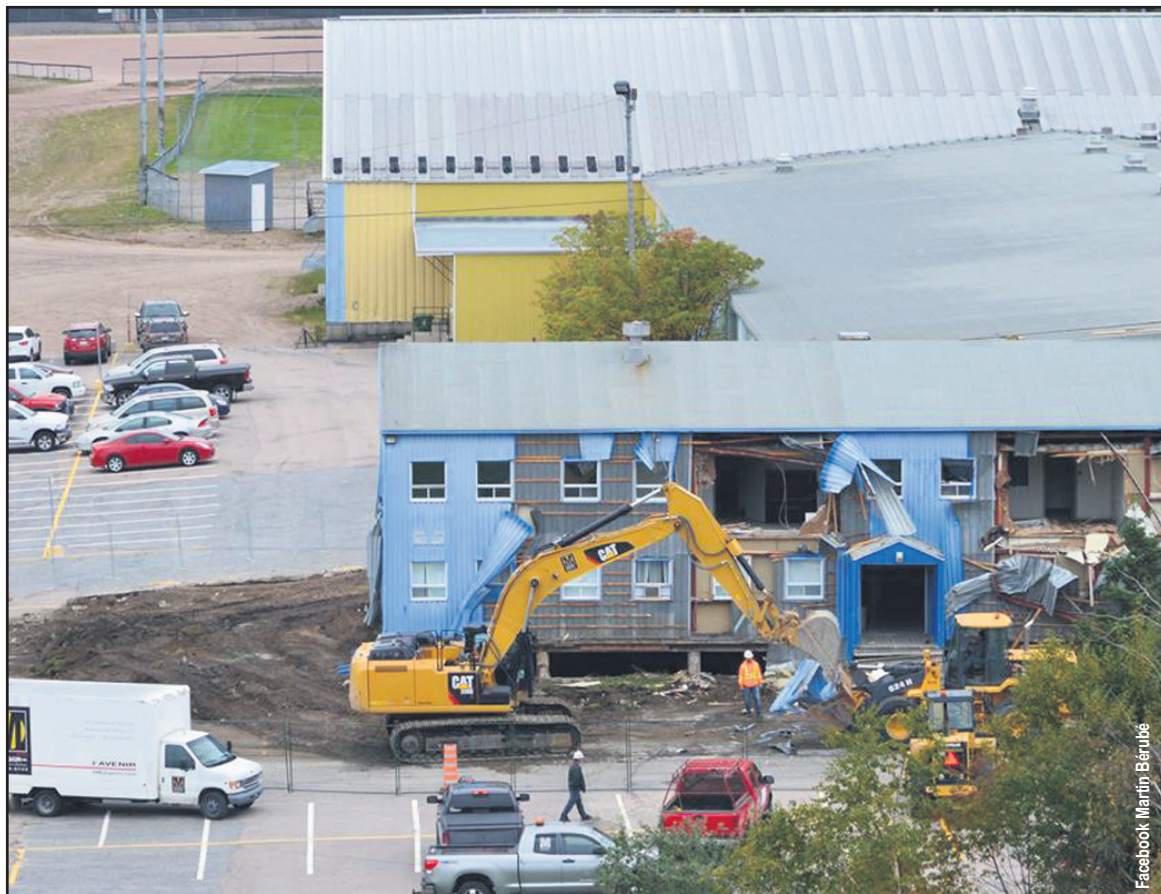
Les travaux de démolition de l'ancien pavillon socioculturel du centre Henri-Desjardins ont été réalisés au début de la semaine dernière.
