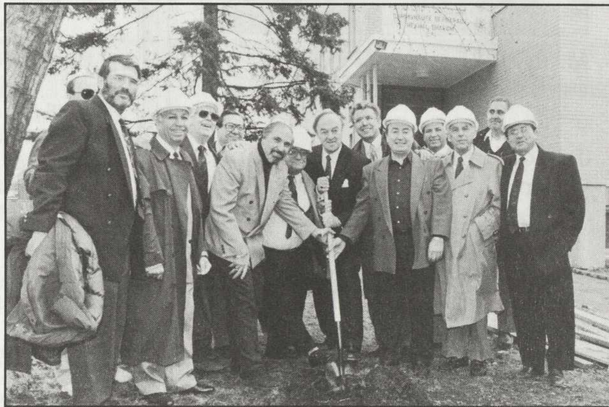
17 avril 1994. Première pelletée de terre des travaux d'agrandissement de la synagogue Hekhal Shalom, rue Gratton
