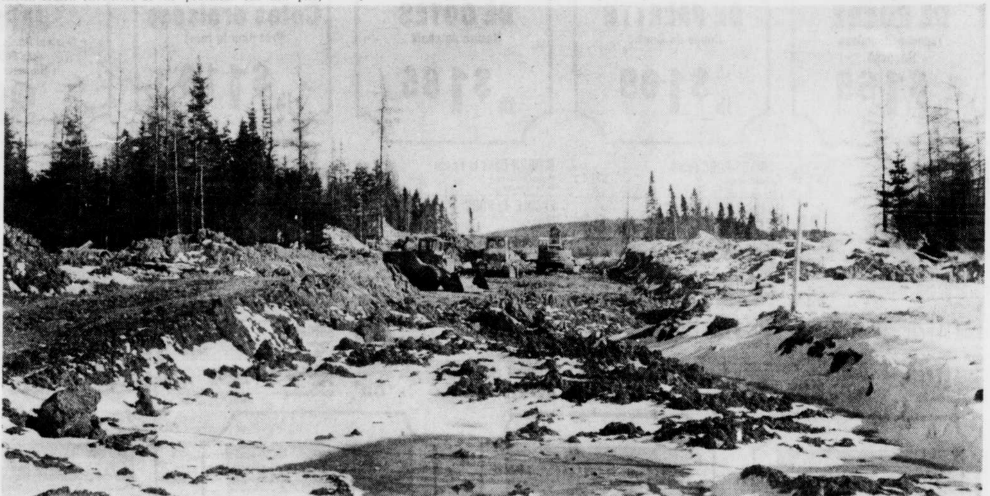
D'importants travaux de réfection sont présentement en cours sur la 9ième rue est à Thetford Mines. Le règlement d'emprunt de $650,000 permettra également l'installation d'une station de pompage au lac à la Truite et le prolongement de la 9ième rue ouest. (Photo La Tribune, Jacques Dussault)
