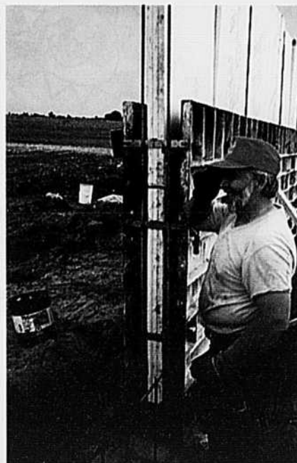
Les murs de l'étable en béton, de 10 pouces d'épais, sont isolés par 3 pouces de polystyrène expansé.
