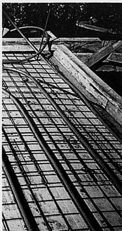
Tuyaux de chauffage dans les planchers de béton. Photo: Société Rochat
