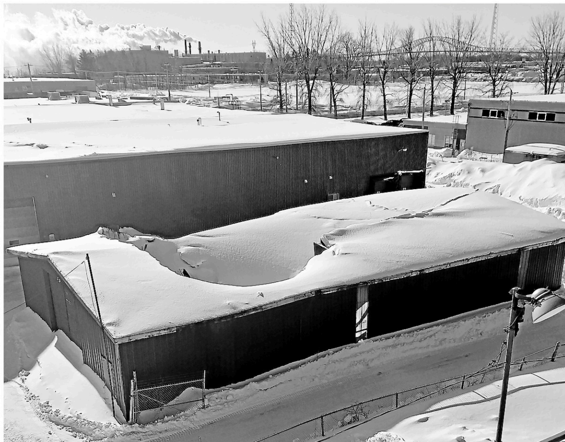
La toiture de ce bâtiment, situé sur la rue Père-Daniel, à Trois-Rivières, s'est affaissée. — PHOTO: STÉPHANE NADEAU
