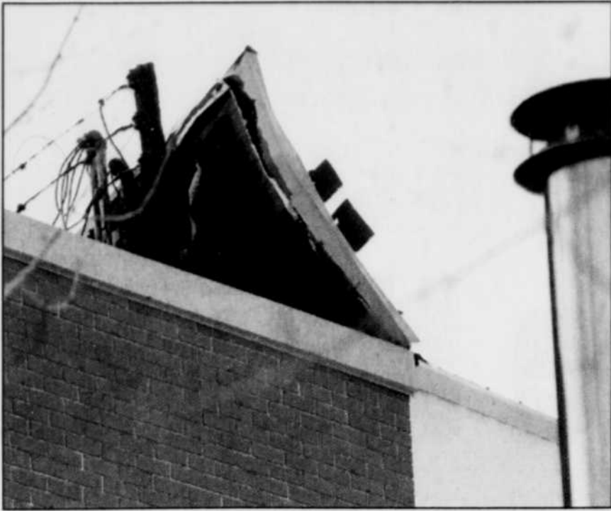
Les vents violents ont eu raison de la toiture d'un immeuble de trois étages, situé au 1087, rue Lambert à Shawinigan.
