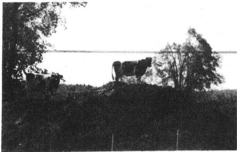
Aux trois fourches (rang Saint-Augustin et route 348) les vaches peuvent maintenant vous toiser de haut, grâce à cet amoncellement de terre laissé par les travaux de pose de l'émissaire de l'usine de traitement des eaux usées de Saint-Gabriel.
