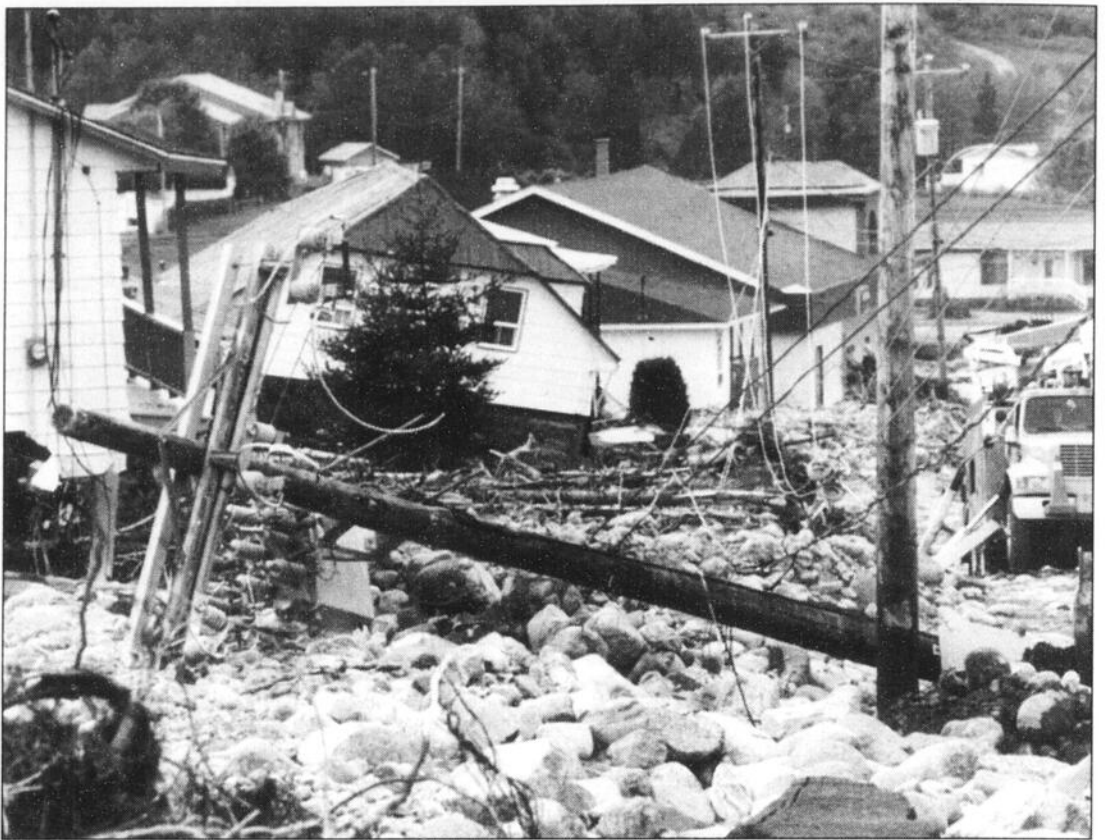
TRISTESSE - Cette scène démontre à quel point les dégâts ont été lourds à Anse-Saint-Jean. (Photo Rocket Lavoie)
