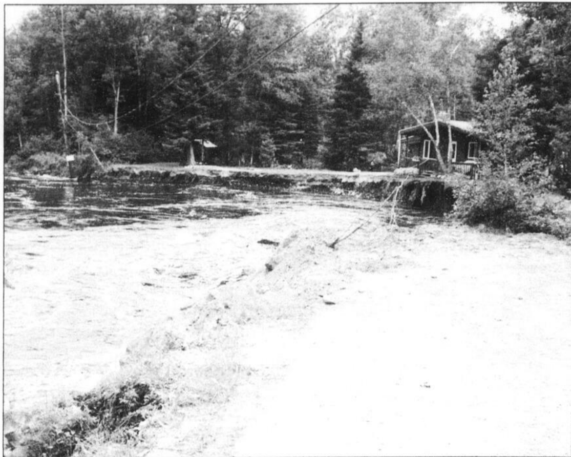
NOUVEAU LIT - En descendant les montagnes des Laurentides, les eaux déchaînées de la Belle-Rivière ont emporté complètement la route sur une longueur de 2000 pieds.
