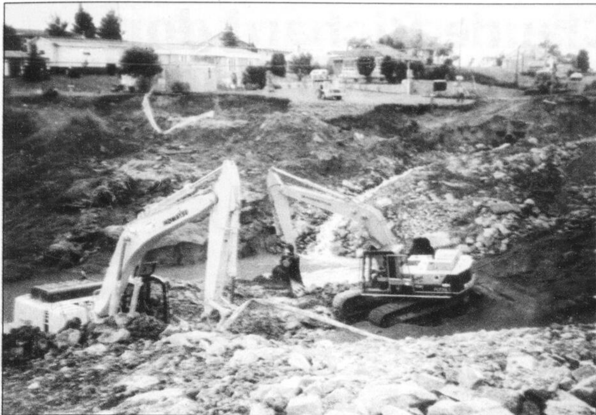
LE TRONÇON de la route 170 détruit par la force des eaux près du restaurant Bobbie à Jonquière est en pleine reconstruction.
