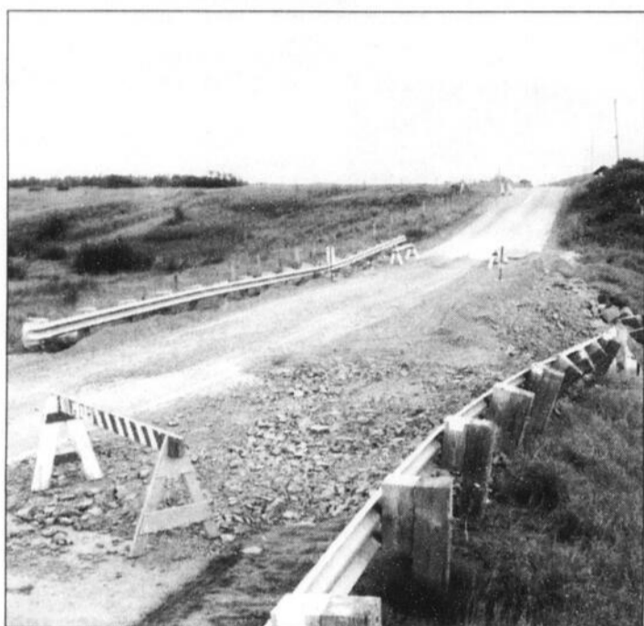
CHEMIN - A l'instar d'autres municipalités de la région, celle de Larouche a également été touchée par les inondations et plusieurs bouts de chemins ont été emportés.
