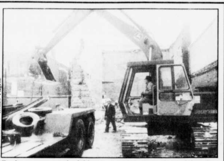
Quelques travaux de déblayage ont été entrepris en début de semaine sur les lieux sinistrés, mais on attend toujours que les propriétaires des Terrasses du Platon se manifestent et demandent un permis de démolition.
