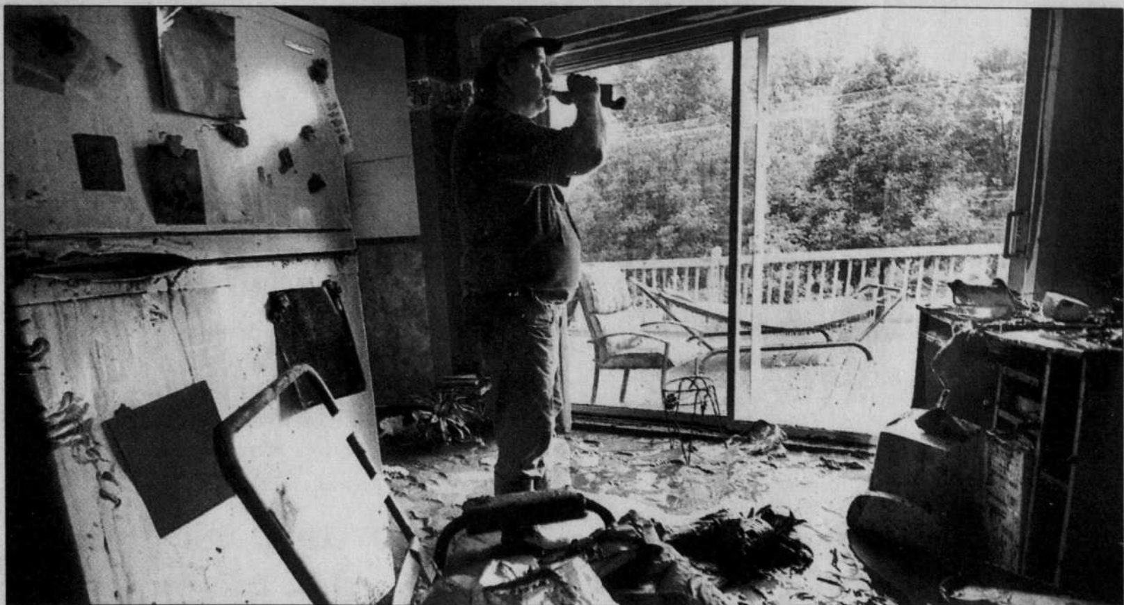
Une gorgée de coca-cola pour Alain Vaudreuil, venu aider sa nièce Renée à réparer les dégâts dans sa maison de Warwick, près de la rivière Nicolet. (PATRICK SANFAÇON LE DEVOIR)
