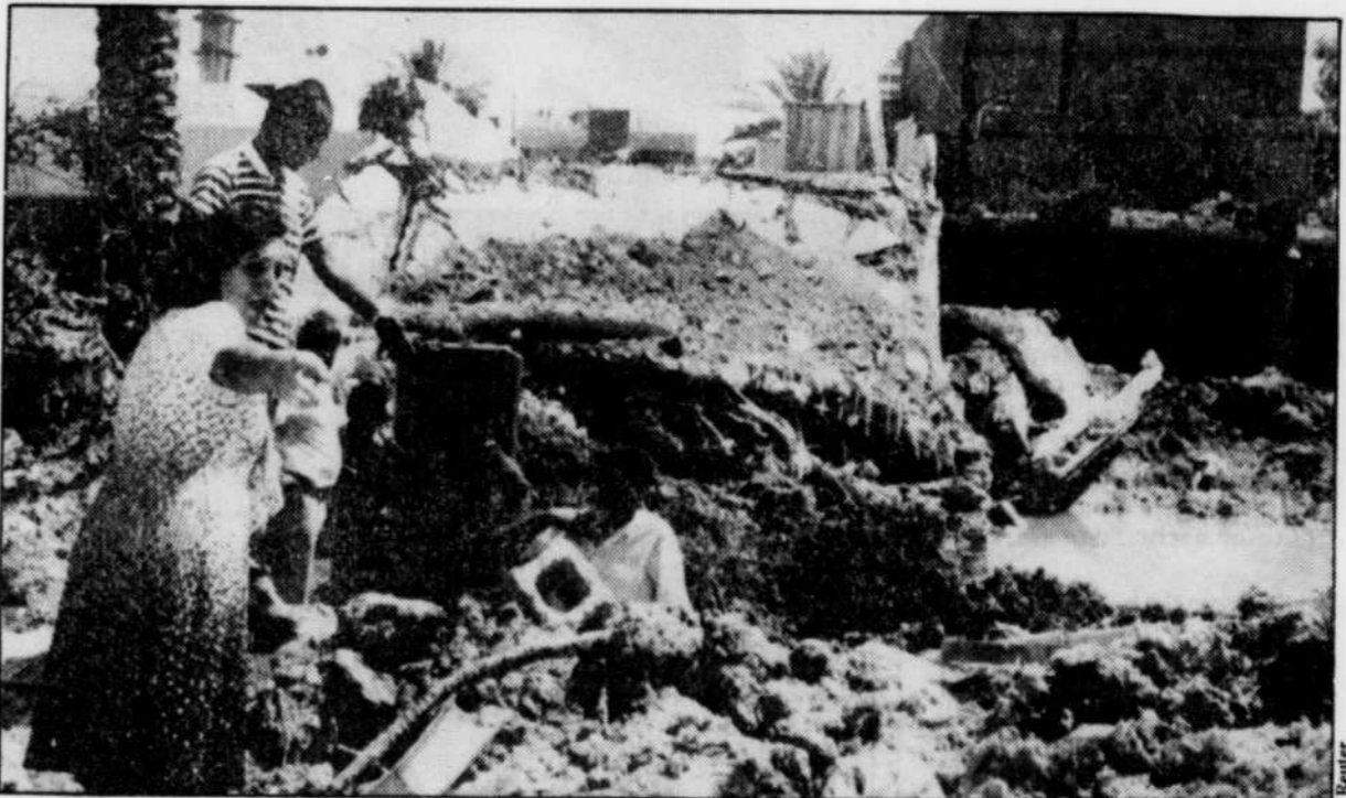
Une ingénieure irakienne dirige les travaux de déblaiement et de réparation au quartier général des services secrets irakiens, dévasté par le raid américain de samedi dernier.
