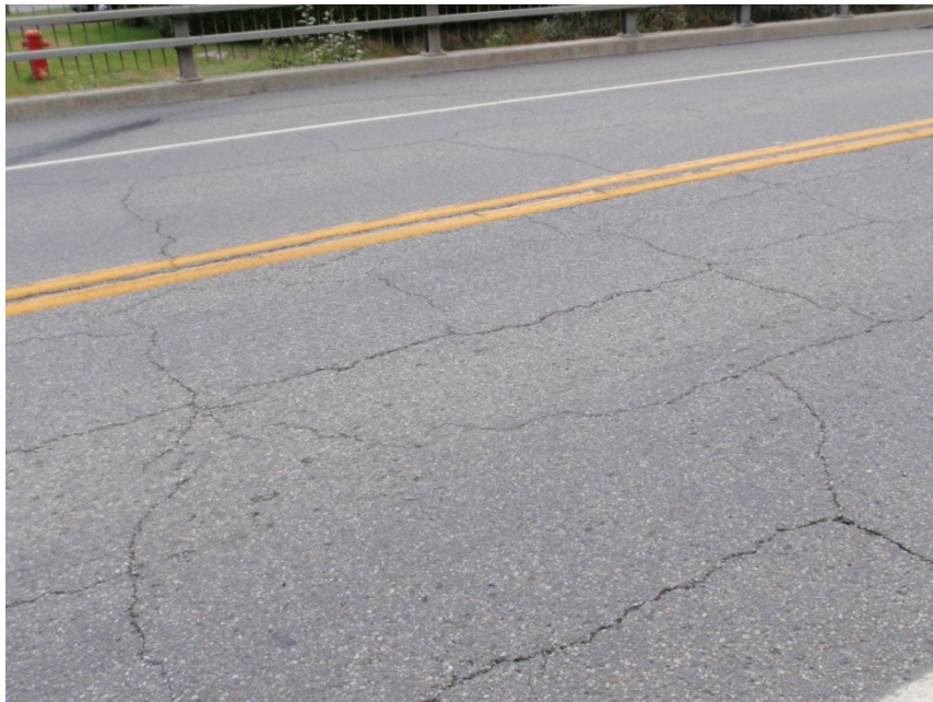
Photo 4.7-1 b) Fissures polygonales dans l'enrobé
