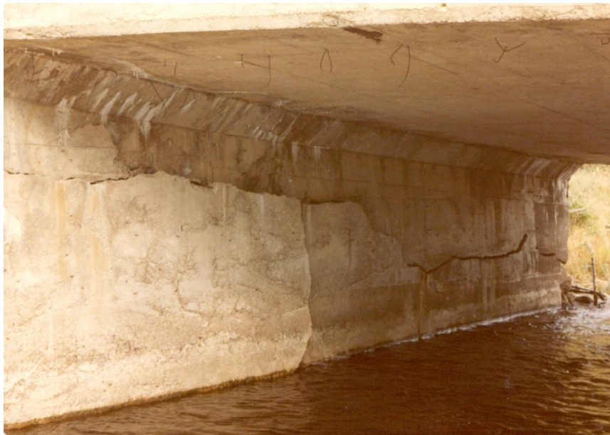
Photo 4.2-5 c) Fissures causées par des tassements différentiels
