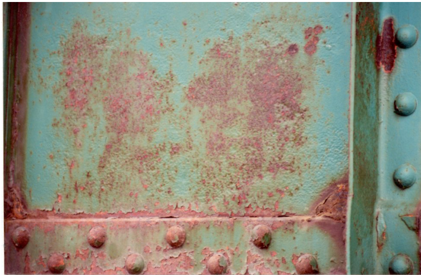
Photo 4.4-1 a) Corrosion légère d'un élément en acier
