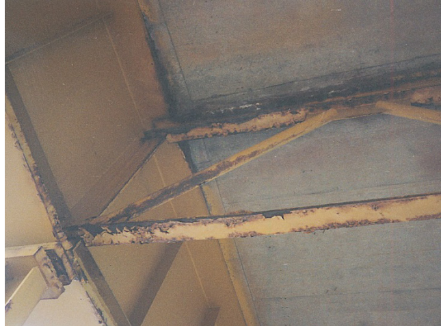
Photo 10.3-1 Revêtement absent ou corrosion sous le feuill
