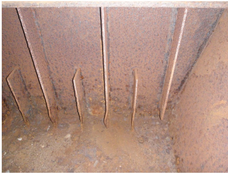
Photo 4.4-3 c) Voilement de raidisseurs à l'intérieur d'une poutre-caisson
