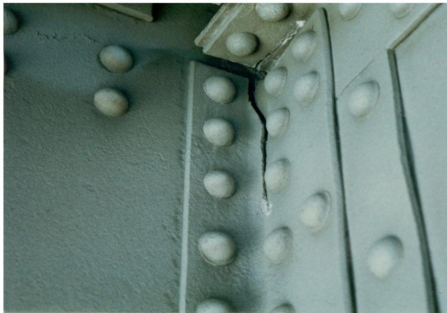
Photo 4.4-2 b) Fissure dans un assemblage riveté
