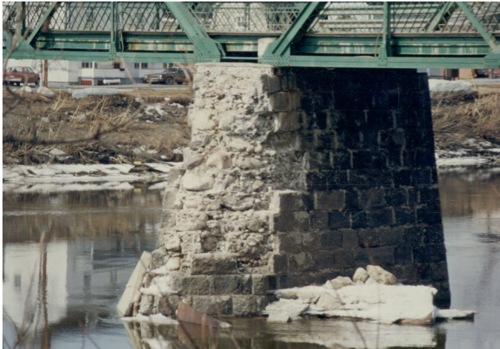
Photo 4.3-2 Décollement des pierres du revêtement d'une pile par l'eau et les glaces (désagrégation très importante)
