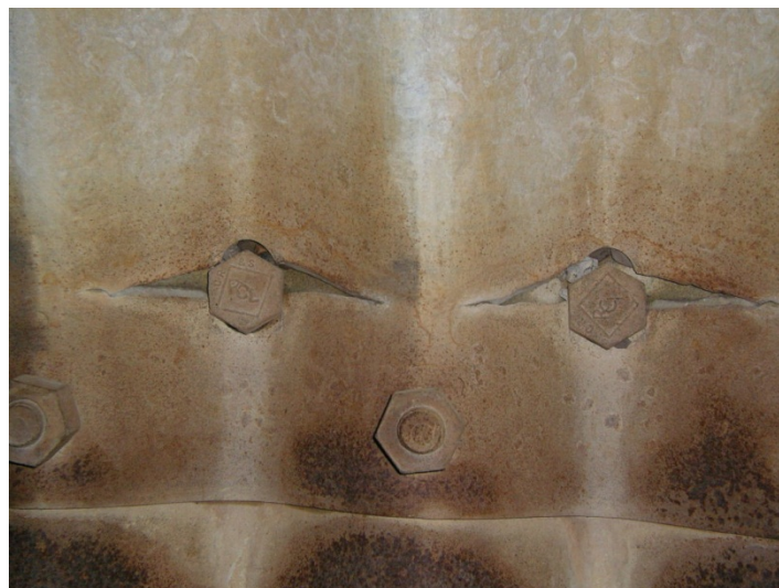
Photo 12.3-1 Fissuration au pourtour des boulons d'un ponceau en acier
