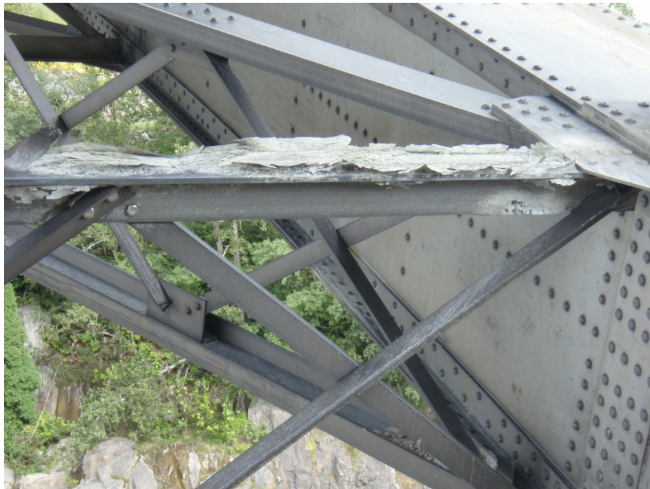
Photo 4.5-1 c) Corrosion importante de l'aluminium
