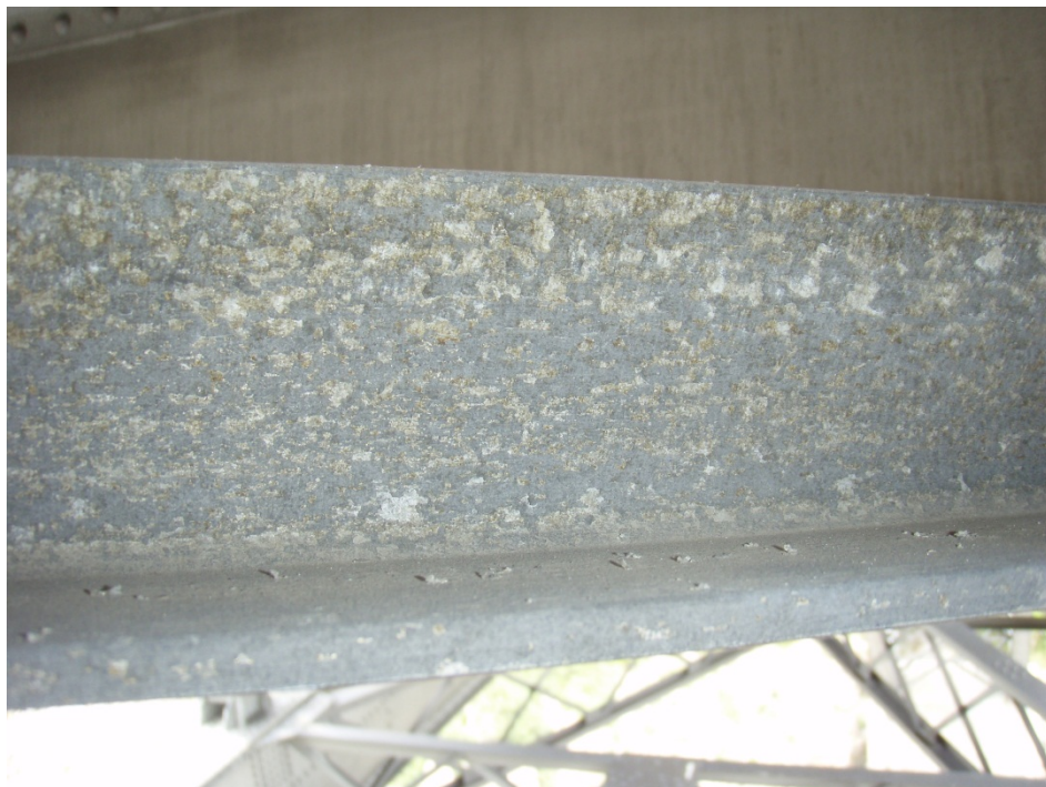
Photo 4.5-1 b) Corrosion moyenne de l'aluminium
