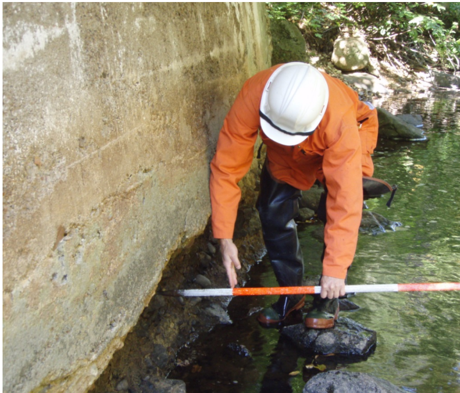
Photo 4.2-1 d) Érosion très importante de la partie inférieure du mur de front
