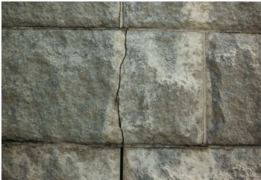
Photo 4.3-1 Fissure moyenne dans la pierre et les joints d'un ouvrage en maçonnerie
