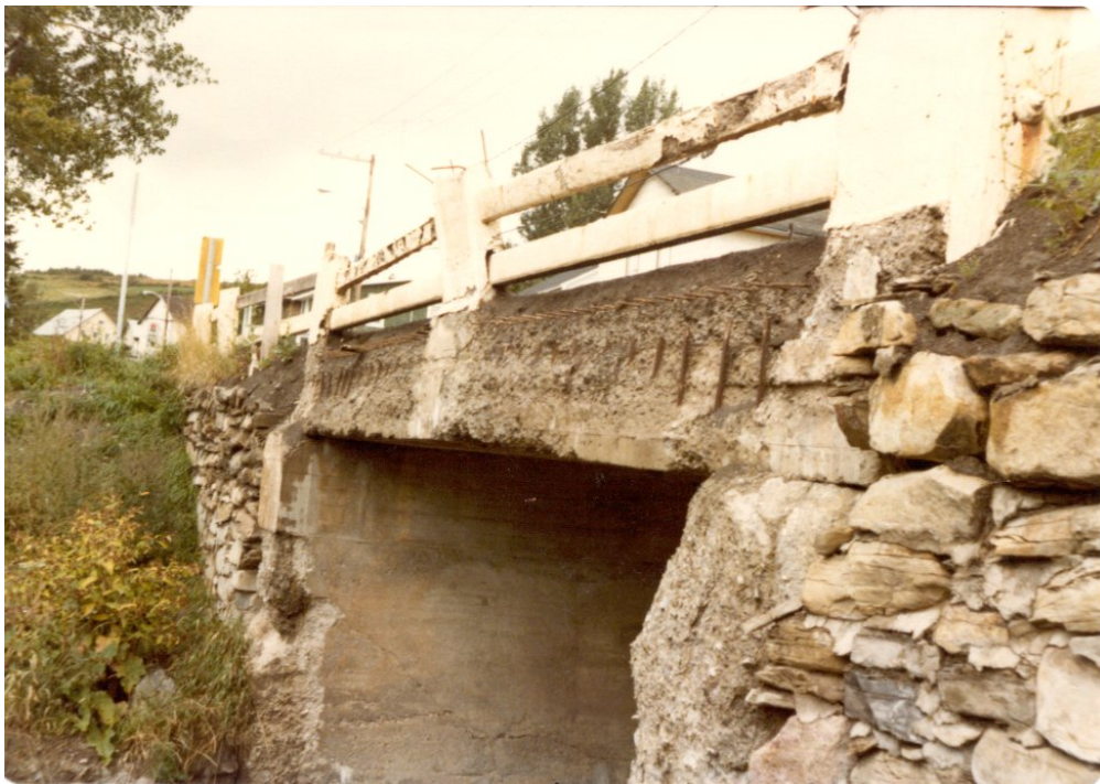
Photo 4.2-1 b) Désagrégation très importante du côté extérieur d'un pont
