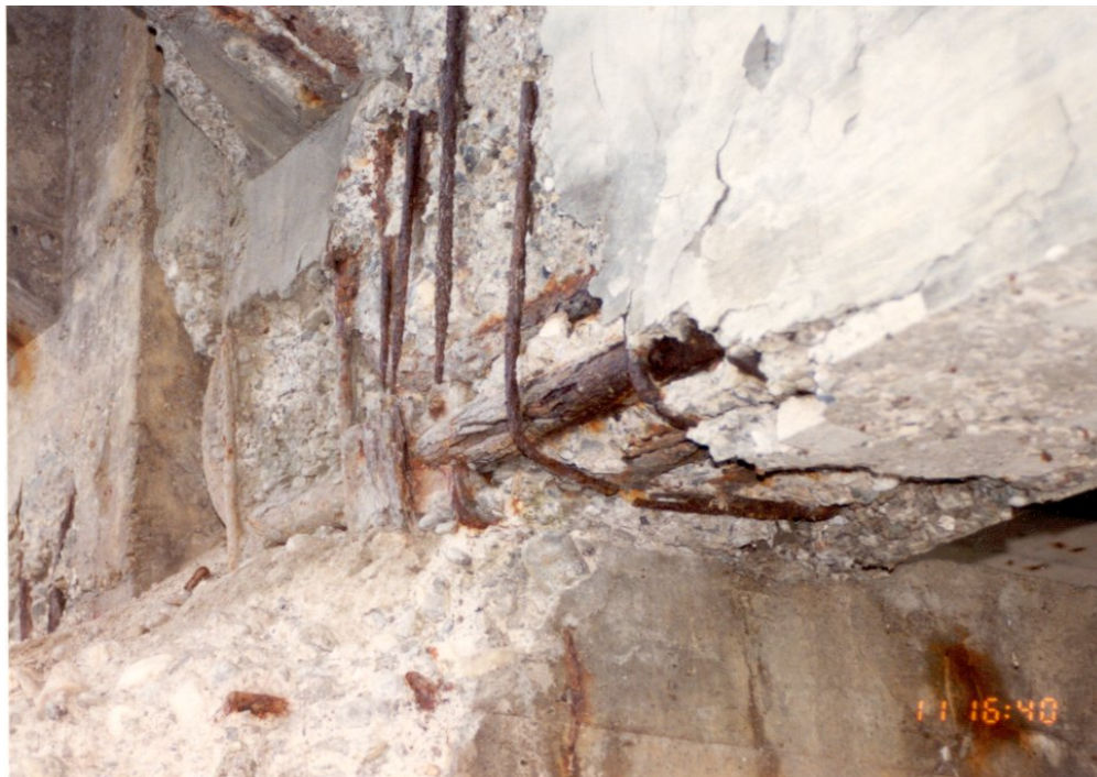
Photo 4.2-2 c) Corrosion très importante de l'armature et barres sectionnées
