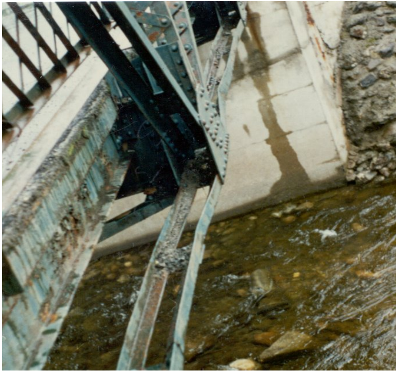
Photo 4.4-3 a) Déformation de la corde inférieure d'une poutre triangulée
