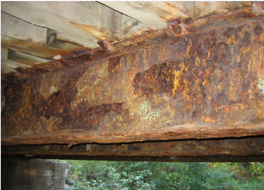
Photo 4.4-1 c) Corrosion importante d'une poutre à âme pleine
