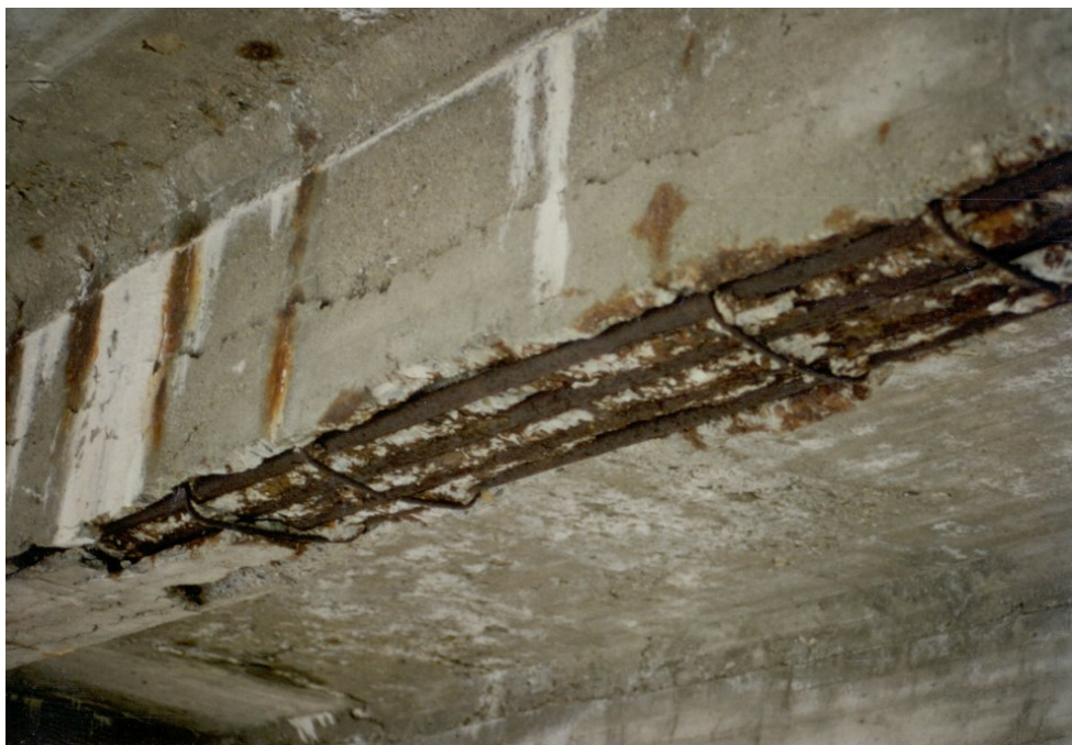
Photo 4.2-4 c) Éclatement et délaminage en dessous d'une poutre
