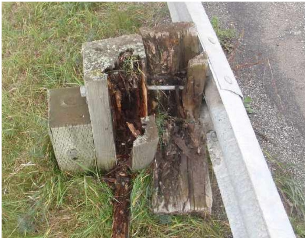
Photo 4.6-1 c) Pourriture très importante d'un poteau de glissière à l'approche
