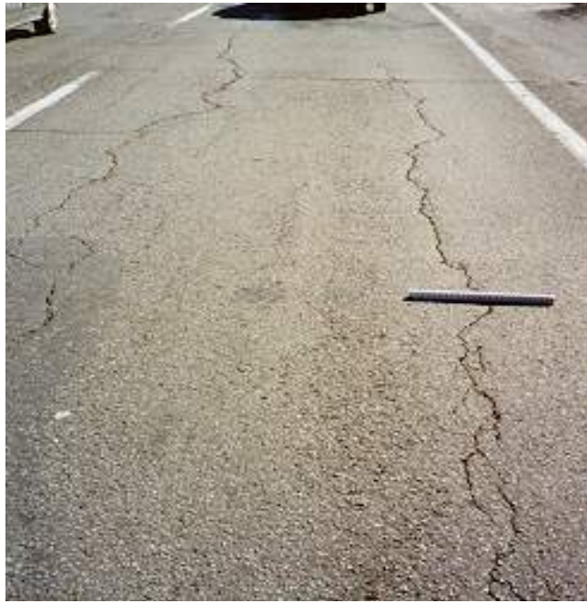
Photo 4.7-1 a) Fissures longitudinales dans l'enrobé
