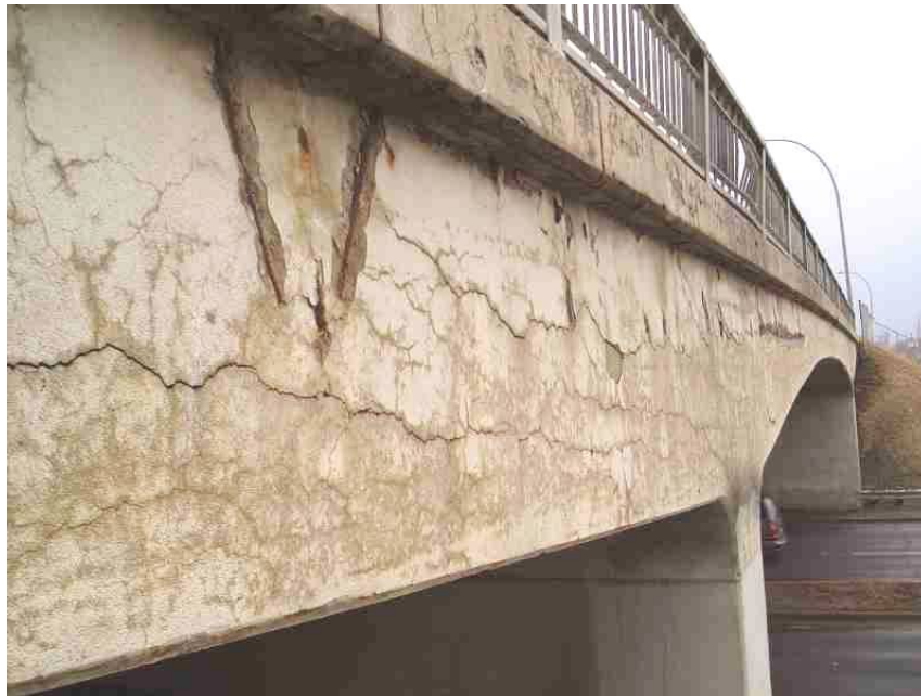
Photo 4.2-5 b) Fissures causées par la réaction alcali-granulat
