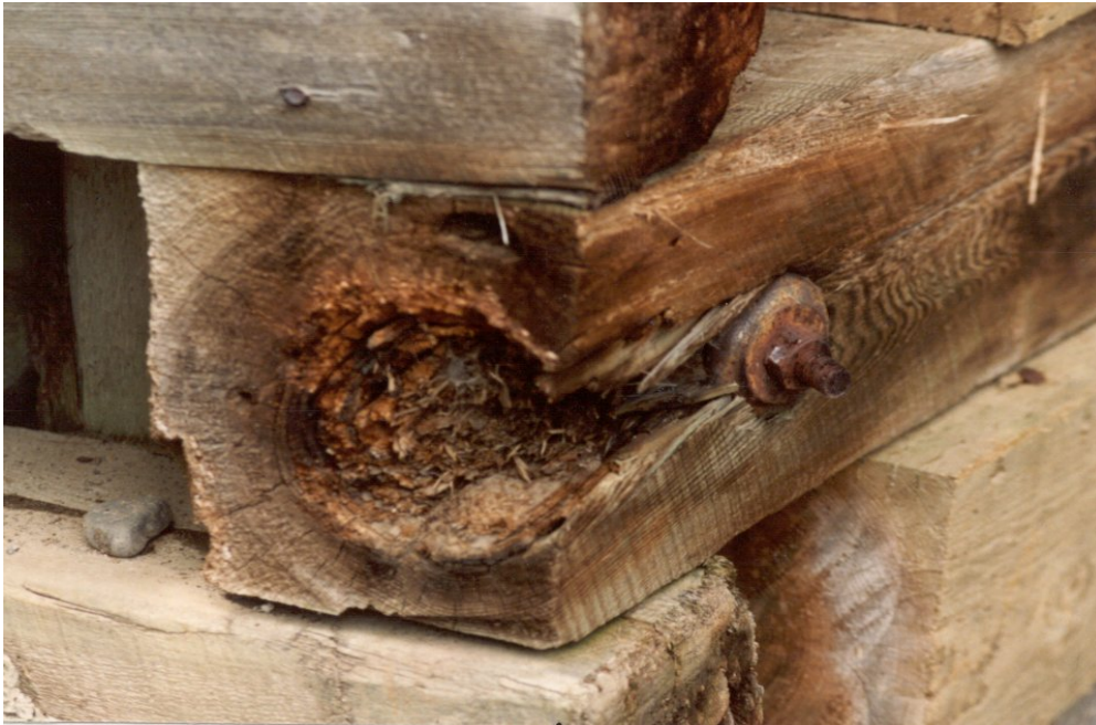
Photo 4.6-1 b) Pourriture importante de l'extrémité d'une pièce de caisson
