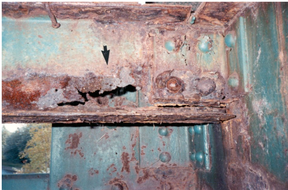
Photo 4.4-1 d) Corrosion très importante d'un longeron
