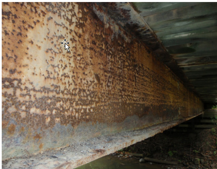
Photo 4.4-1 b) Corrosion moyenne d'une poutre à âme pleine
