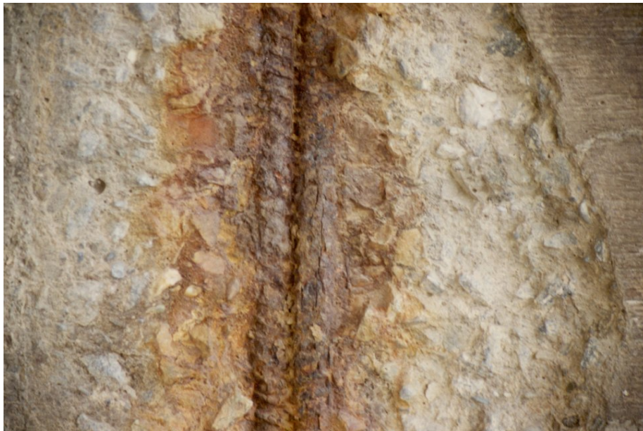
Photo 4.2-2 b) Armature apparente rouillée, mais diminution de section négligeable Corrosion moyenne de l'armature
