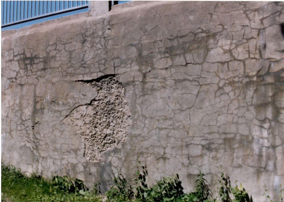
Photo 4.2-1 a) Désagrégation moyenne d'un mur de soutènement
