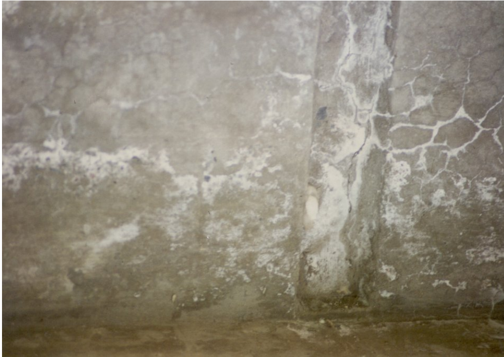
Photo 4.2-6 b) Efflorescence sous une dalle
