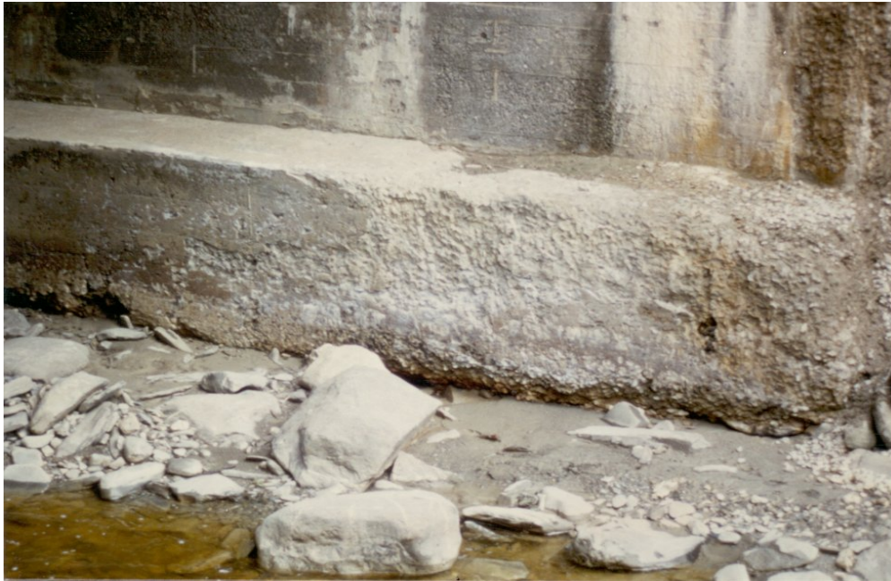
Photo 4.2-1 c) Érosion légère de la semelle d'une pile
