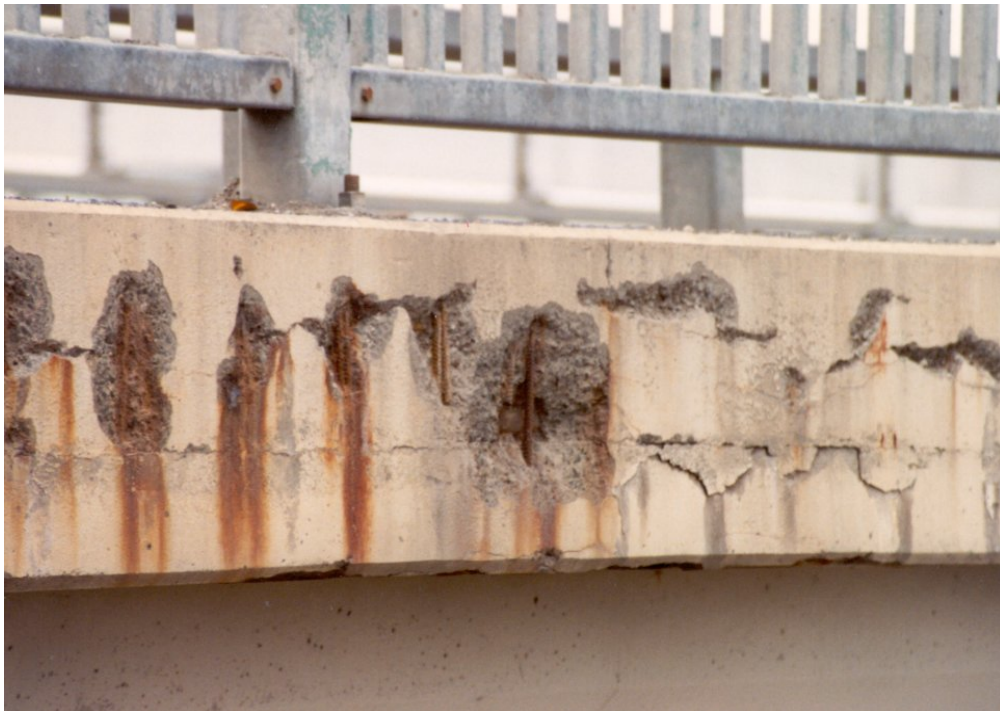
Photo 4.2-4 b) Éclatement du béton du côté extérieur d'un pont dû à la corrosion de l'armature
