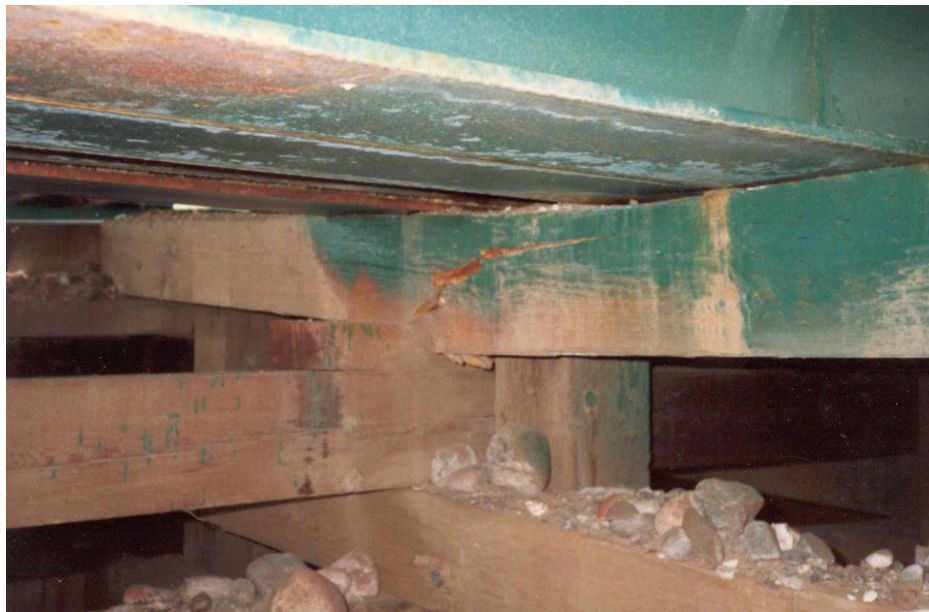
Photo 4.6-3 c) Rupture d'une pièce de caisson
