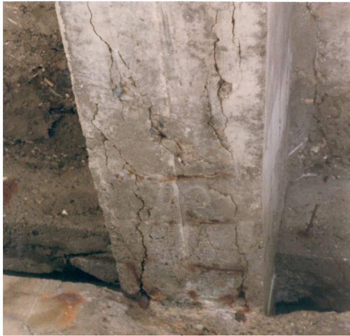
Photo 4.2-3 a) Délaminage du dessous d'une poutre
