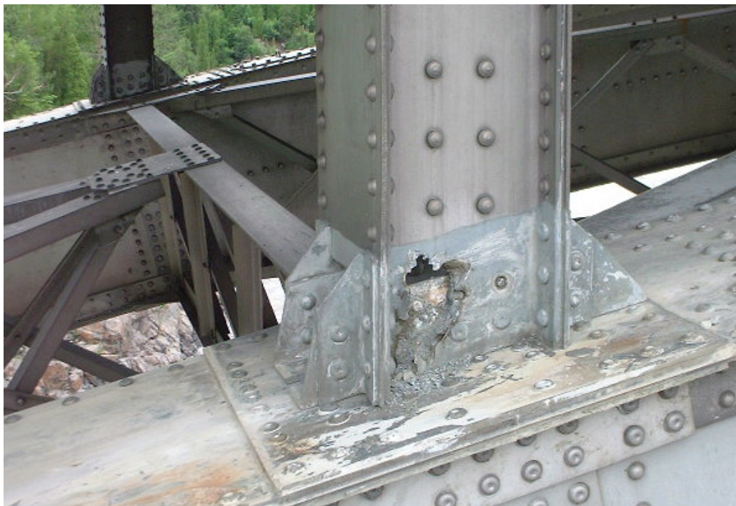
Photo 4.5-1 d) Corrosion très importante et perforation de l'aluminium
