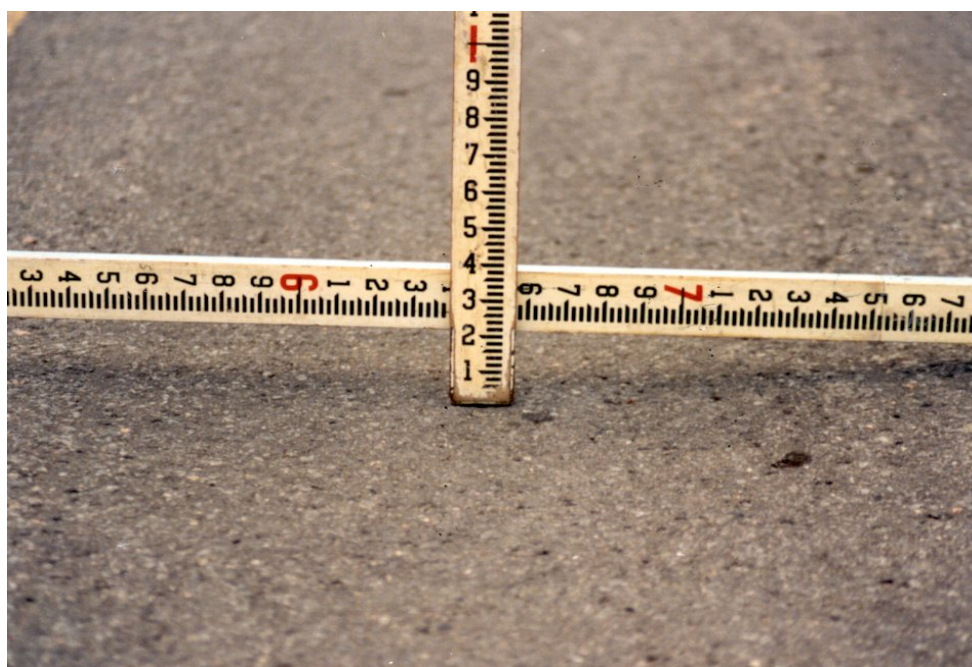
Photo 4.7-3 a) Orniérage important
