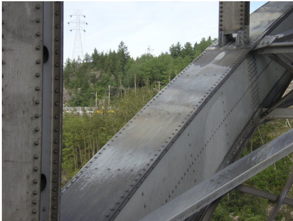
Photo 4.5-1 a) Corrosion légère de l'aluminium
