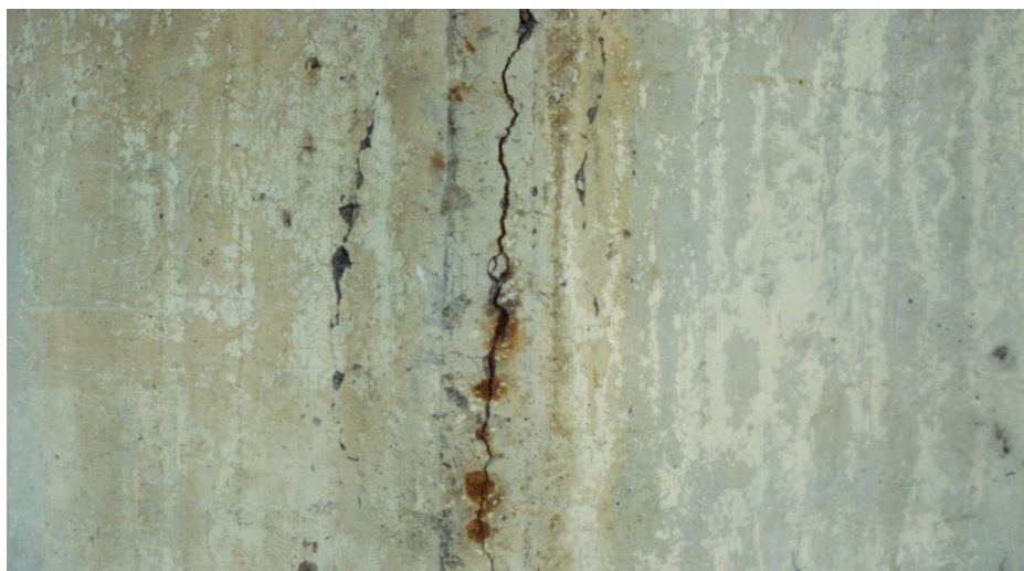
Photo 4.2-5 a) Fissures causées par la corrosion de l'armature
