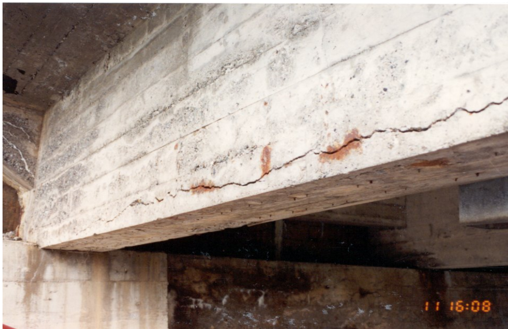
Photo 4.2-3 b) Délaminage du dessous d'une poutre
