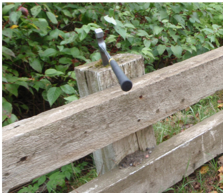
Photo 4.6-1 a) Pourriture moyenne d'un poteau de glissière
