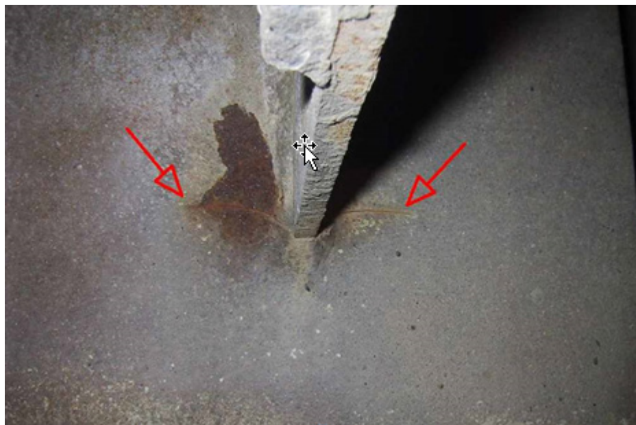
Photo 4.4-2 d) Fissure dans l'âme d'une poutre à l'extrémité d'un raidisseur
