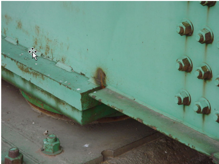
Photo 4.4-2 c) Fissure dans une zone de discontinuité
