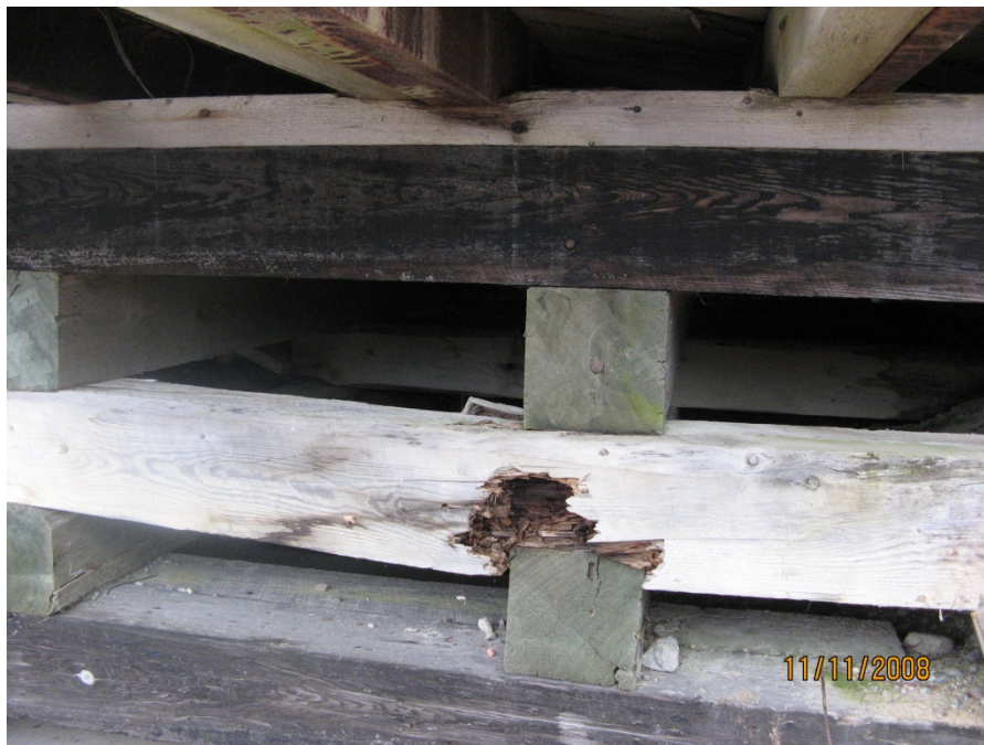
Photo 4.6-3 d) Écrasement d'une pièce de caisson
