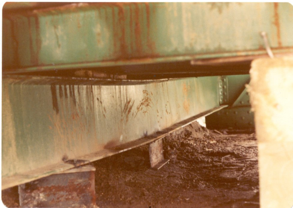
Photo 4.4-3 b) Fléchissement d'une entretoise
