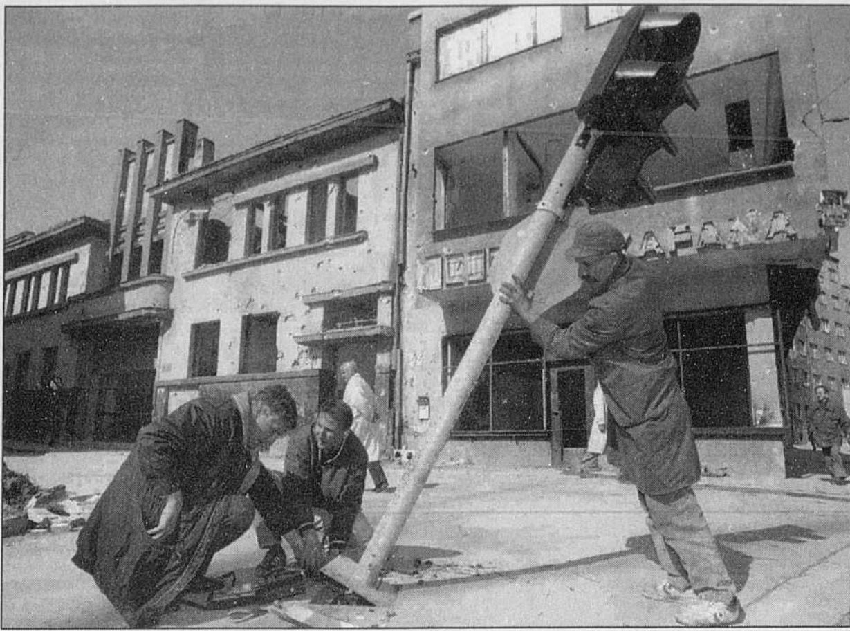
APRÈS UN MOIS DE PAIX, la ville de Sarajevo reprend petit à petit un visage normal. Ces ouvriers installent des feux de circulation à un carrefour qui porte encore les marques des bombardements qui ont en partie détruit la capitale bosniaque.
