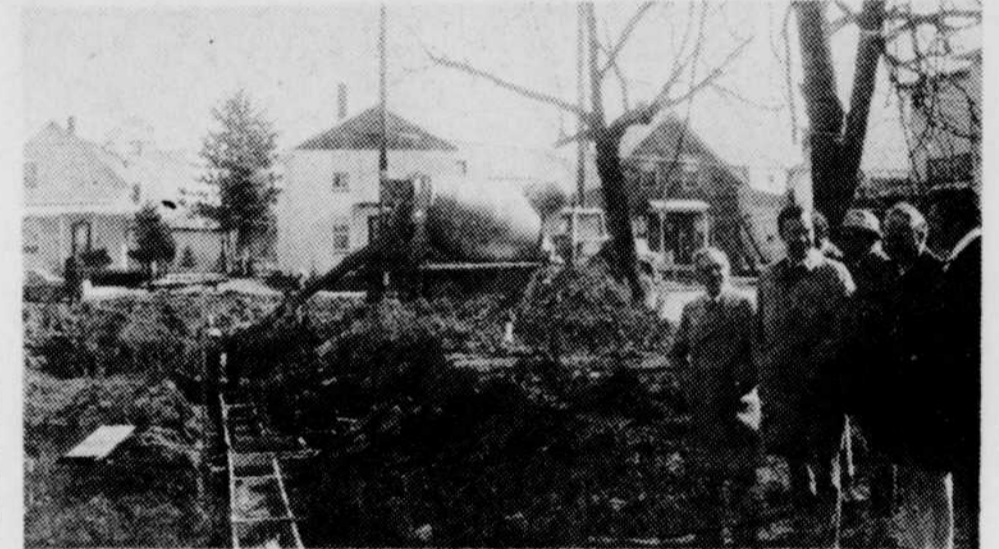
La construction de 20 autres logements à prix modique vient de débuter à Victoriaville. Se sont rendus hier sur le chantier, le conseiller Robert Provencher qui est le président de l'office d'habitation
