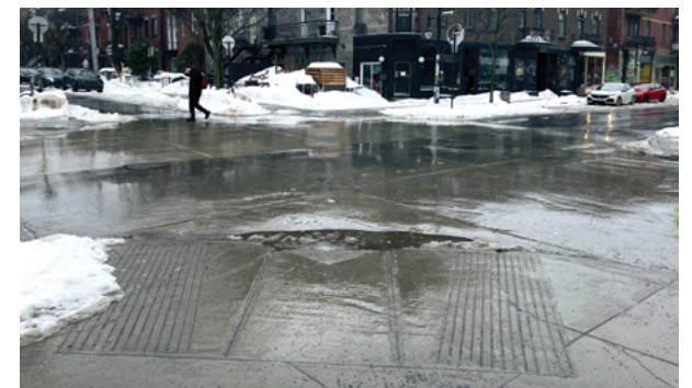
Surélévation insuffisante d'une intersection causant une accumulation d'eau
