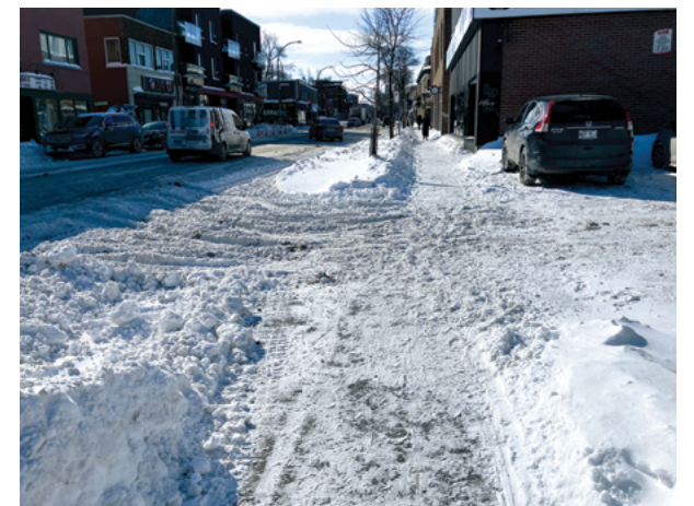
Pente d'une entrée charretière dans le corridor piéton créant des accumulations importantes
