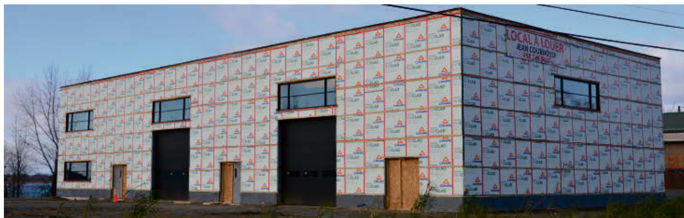
Le nouveau bâtiment construit par Jean Cournoyer situé au 1689, route Marie-Victorin, où le Service animalier Pierre-De Saurel devait déménager. Photo Alexandre Brouillard | Les 2 Rives ©
