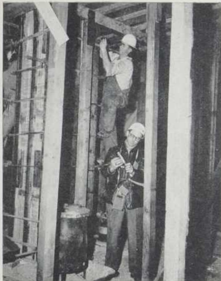
Les salamandres sans cheminée doivent être vérifiées constamment et méticuleusement pour écarter tout risque de concentration de gaz carbonique. Un employé procède ici à cette vérification à l'aide d'un détecteur colorimétrique.
